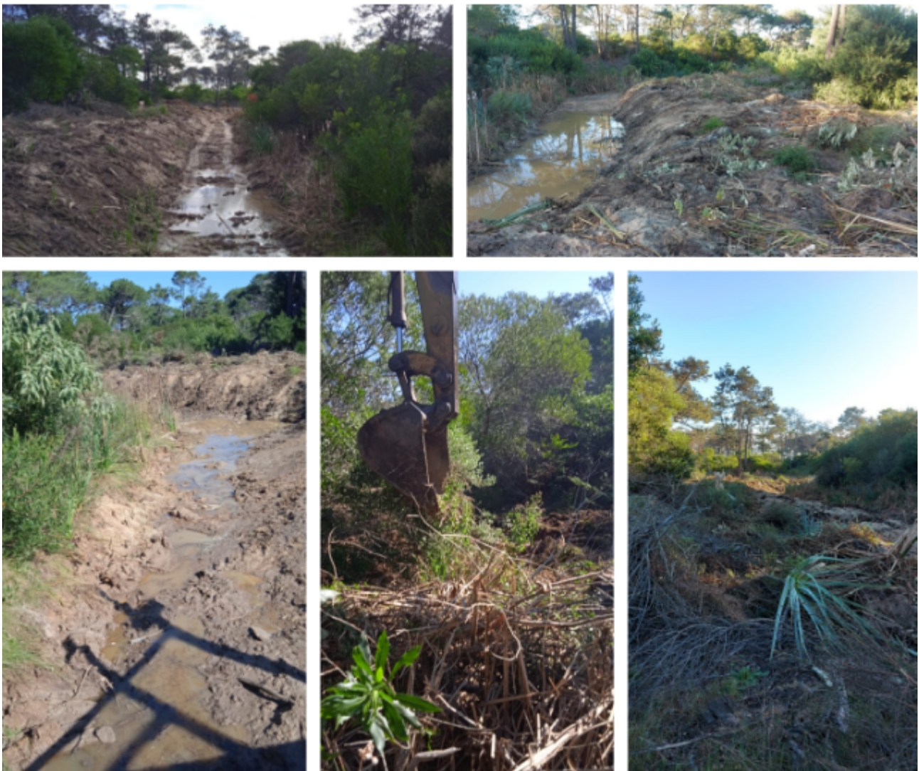
Figura 7. Imágenes de la afectación de la cañada de las Ranas debido a la remoción inadecuada de vegetación con una máquina de gran porte realizada el 28 de abril de 2023.
