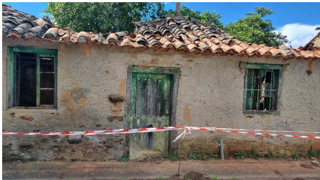
Fig. 2 Exterior de casa en peligro de derrumbe.
