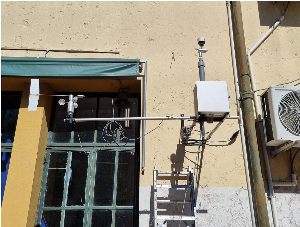
Figura 4.6.4 – Fotografía de la estación Met One E-Sampler 9800 una vez instalada sobre la fachada oeste de la escuela, al sur de las ventanas del salón 2. Se puede apreciar la ménsula, el equipo central y el anemómetro y su veleta.
