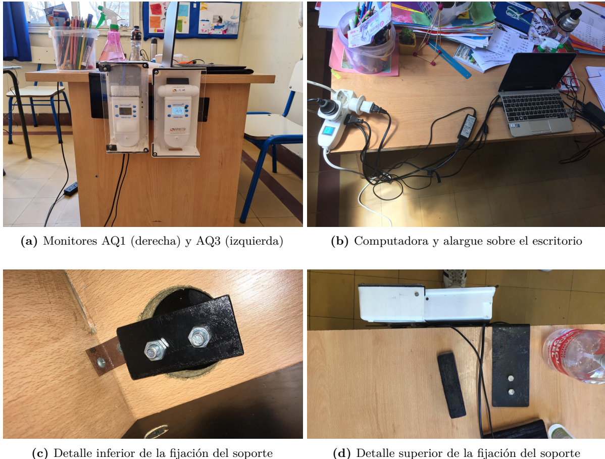
Figura 4.6.2 – Fotografías de la instalación de los monitores AQ1 y AQ3 sobre el escritorio de la maestra, al frente del salón.
