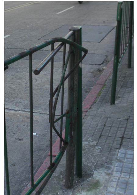
Fig. 13. Elemento que carece de mantenimiento. Fuente: Elaboración propia.
