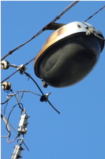
Fig. 11. Elemento de iluminación que se ve afectado por la poca limpieza. | Fuente: Elaboración propia.
