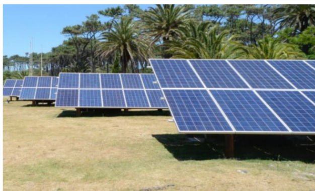
Figura 2. Parque solar fotovoltaico ubicado en las afueras de Montevideo, Uruguay [4].
