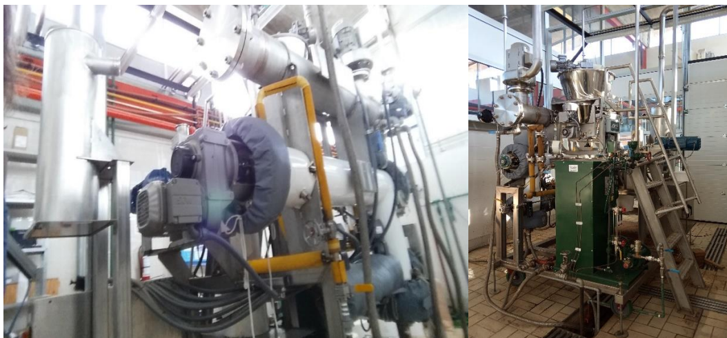
Figura 8-2. Reactor de explosión de vapor utilizado.
