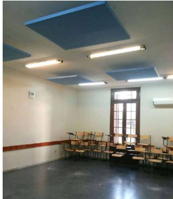
Figura XLIX. Paneles Acústicos Prats en salón de clases
