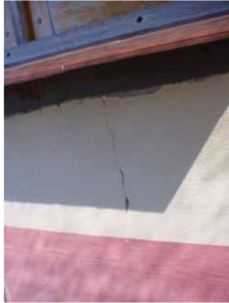
Fisura en antepecho
