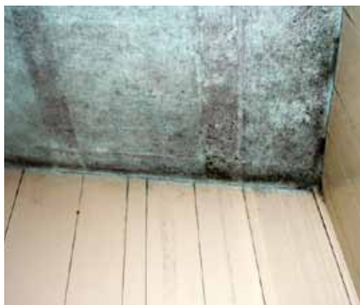
Condensaciones en cielorrasos
