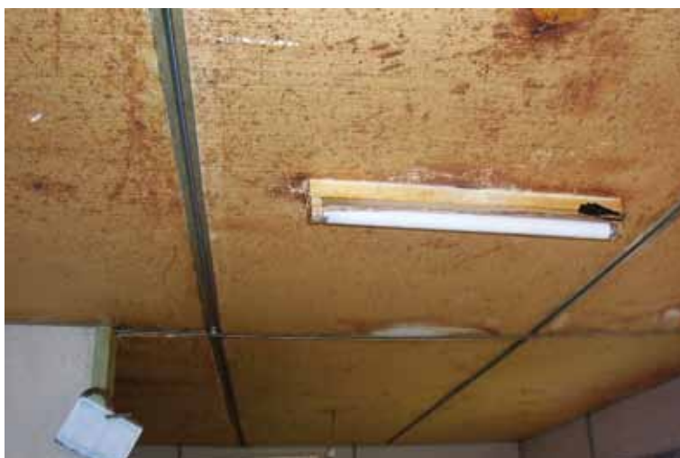
Deterioro de cielorraso
