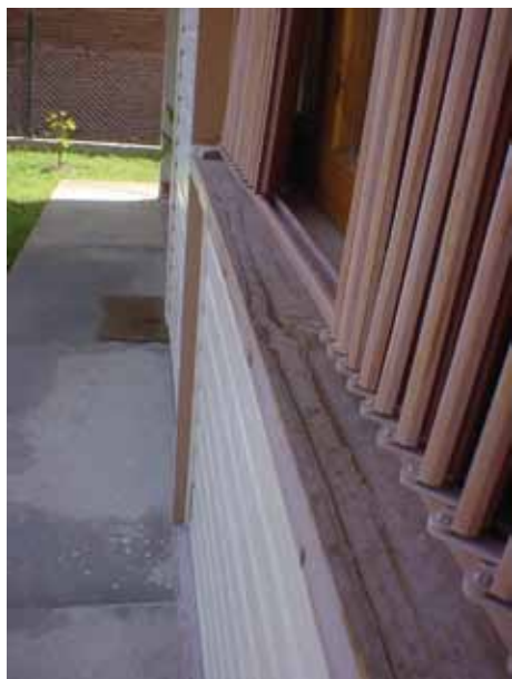
Pintura exterior degradada por agentes atmosféricos
