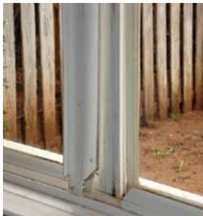
Desperfectos en aberturas
