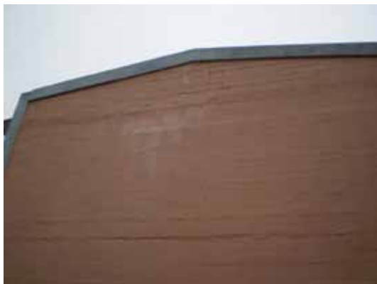
Fisuras en encuentro cumbrera cerramiento vertical
