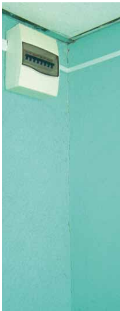
Fisura en encuentro de muros
