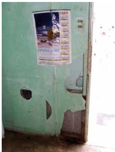
Rotura de paneles
