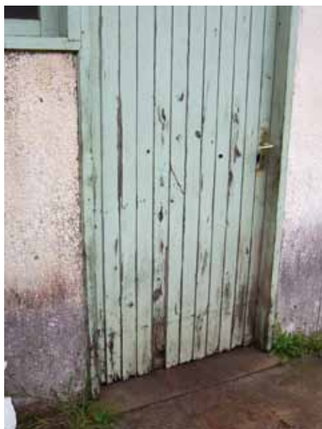
Deterioro de aberturas
