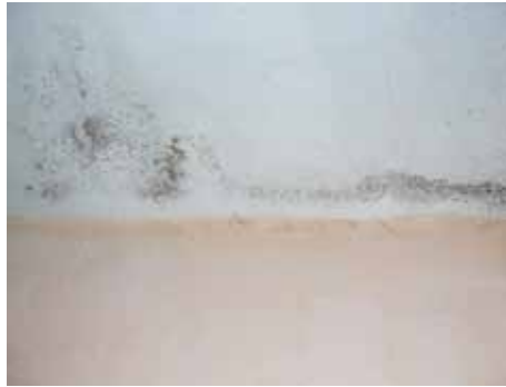
Condensaciones en cielorrasos
