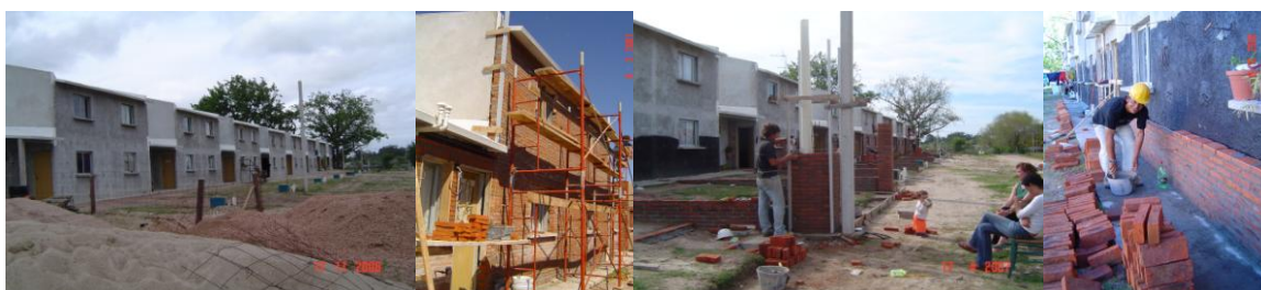
Fig.29 - Viviendas duplex sobre Acosta y Lara – Foto 1: duplex originales, Fotos 2 -3 y 4: proceso de obra, revestimiento de ladrillo, muretes de ladrillo frontales. Foto de la autora, año 2006.
