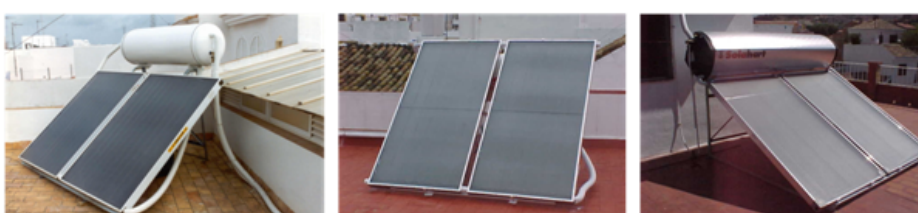
Figura 5.2: Ejemplos de equipos termosifón sobre cubierta plana.
