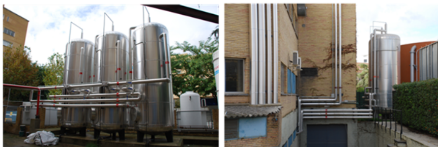
Figura 5.17: Ejemplos de acumuladores situados en el exterior de edificios.
