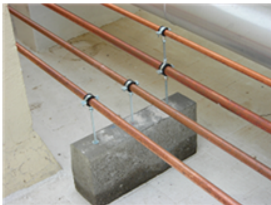
Figura 8.1: Instalación de tuberías de cobre antes de su aislamiento: soportes sin puentes térmicos y con separación suficiente.
