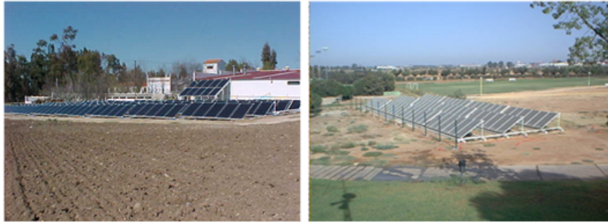
Figura 5.15: Ejemplos de colectores solares en el terreno.
