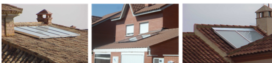
Figura 5.3: Ejemplos de equipos forzados sobre cubiertas inclinadas.
