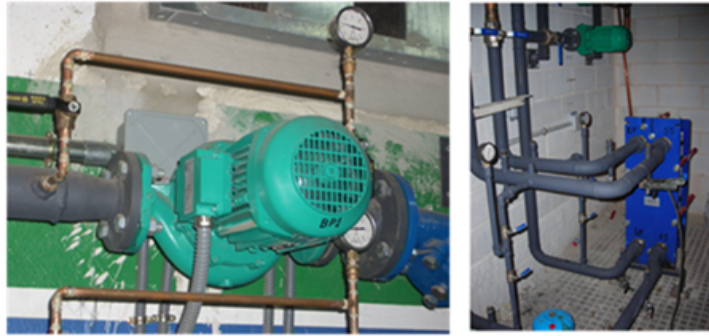
Figura 6.26: Puentes manométricos en bombas de circulación y en ambos circuitos de un intercambiador. Ambos se encuentran en instalaciones solares en fase de montaje.
