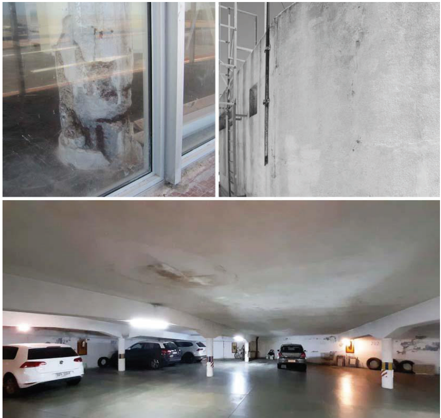
Figura 1: Pérdida de material en un pilar del edificio L'Hirondelle, fisura en el tanque de agua del edificio El Grillo y mancha de óxido en una losa sobre el garaje del edificio Positano.
