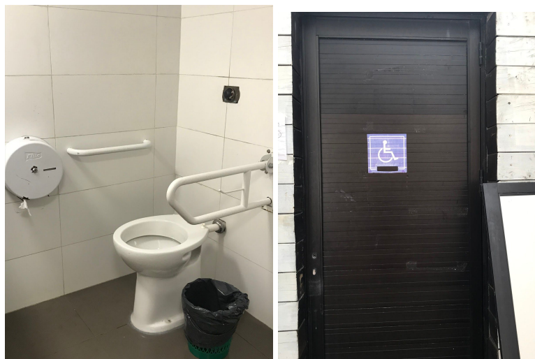
Figura 12 y Figura 13: Interior y exterior de un baño accesible ubicado en Plaza Artigas. Fuente: Autora (2020).
