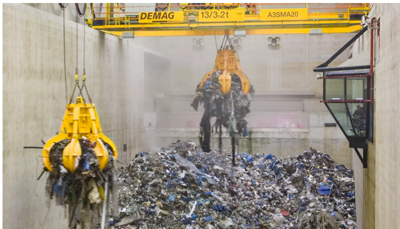
Figura 1.2: Fosa de recepción de residuos (Demag cranes, s.f.)
