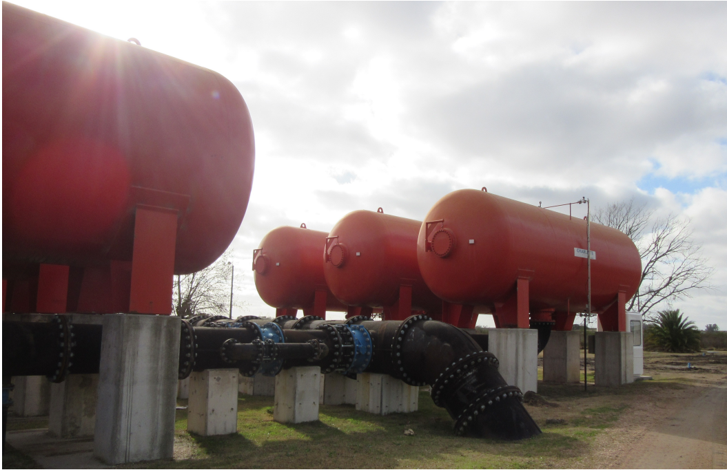
Figura 4.3: Cámaras de aire de la 6 ta línea de bombeo, Aguas Corrientes.
