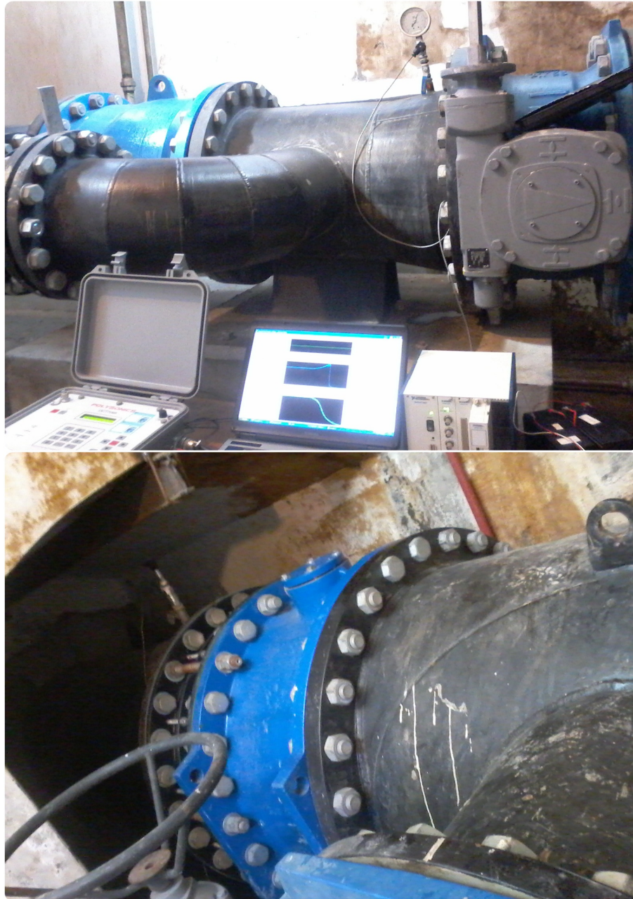
Figura 6.19: Ubicación de los sensores de presión en el cabezal de bombeo.
