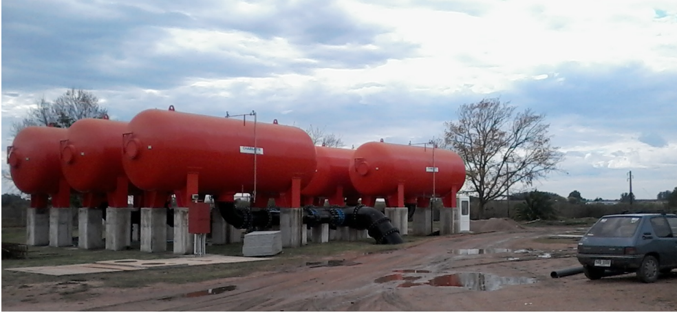
Figura 1.2: Cámaras de aire para la protección antiarrete de la 6 ta línea de bombeo. Aguas Corrientes. OSE.
