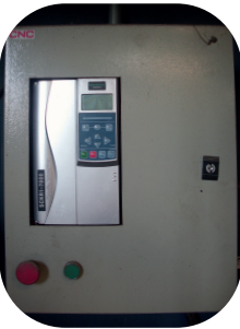
3 Tablero de mando
