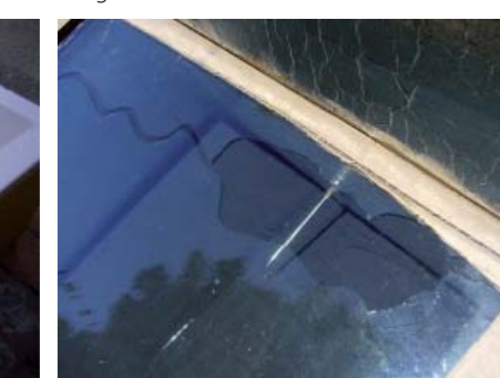
Vidrio inferior quebrado por el calor
