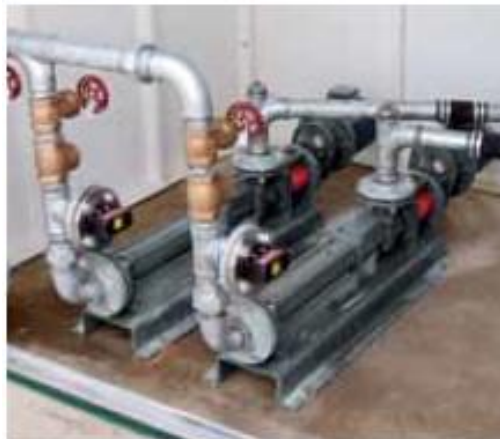
Figura 69: Bombas de cavidad progresiva instaladas en régimen 1+1
