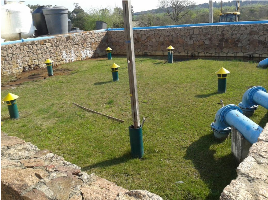
Figura 26: Depósito de agua clara.
