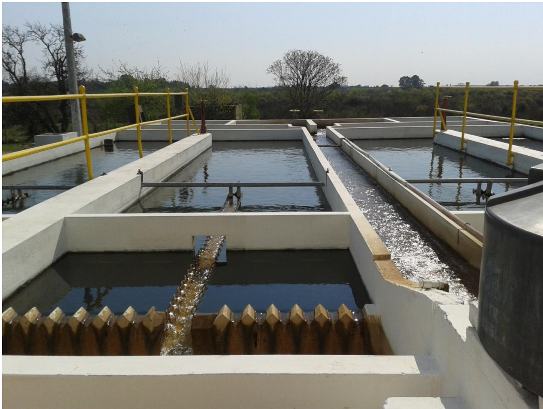
Figura 19: Salida de los sedimentadores con las nuevas canaletas de recolección instaladas
