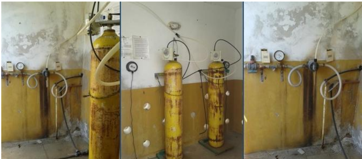
Figura 21: Sistema automático de cloración
