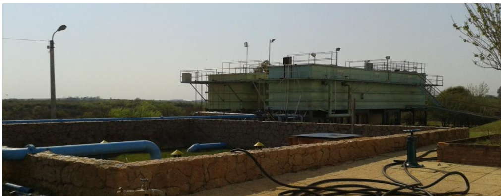
Figura 13: Unidades de Potabilización.
