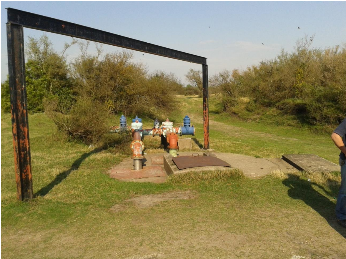
Figura 10: Tuberías y bombas de impulsión.
