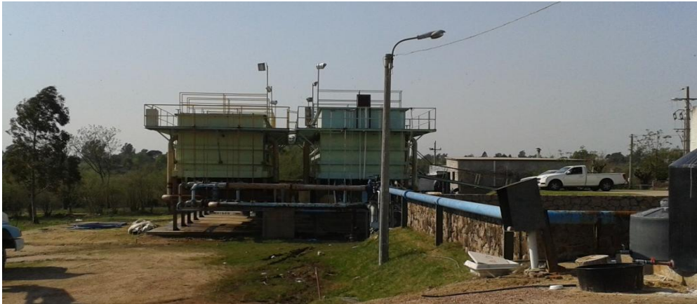
Figura 14 : Unidades de Potabilización vista frontal.
