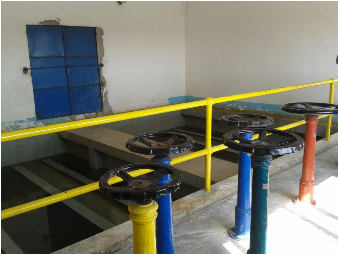
Figura 20: Filtros de arena
