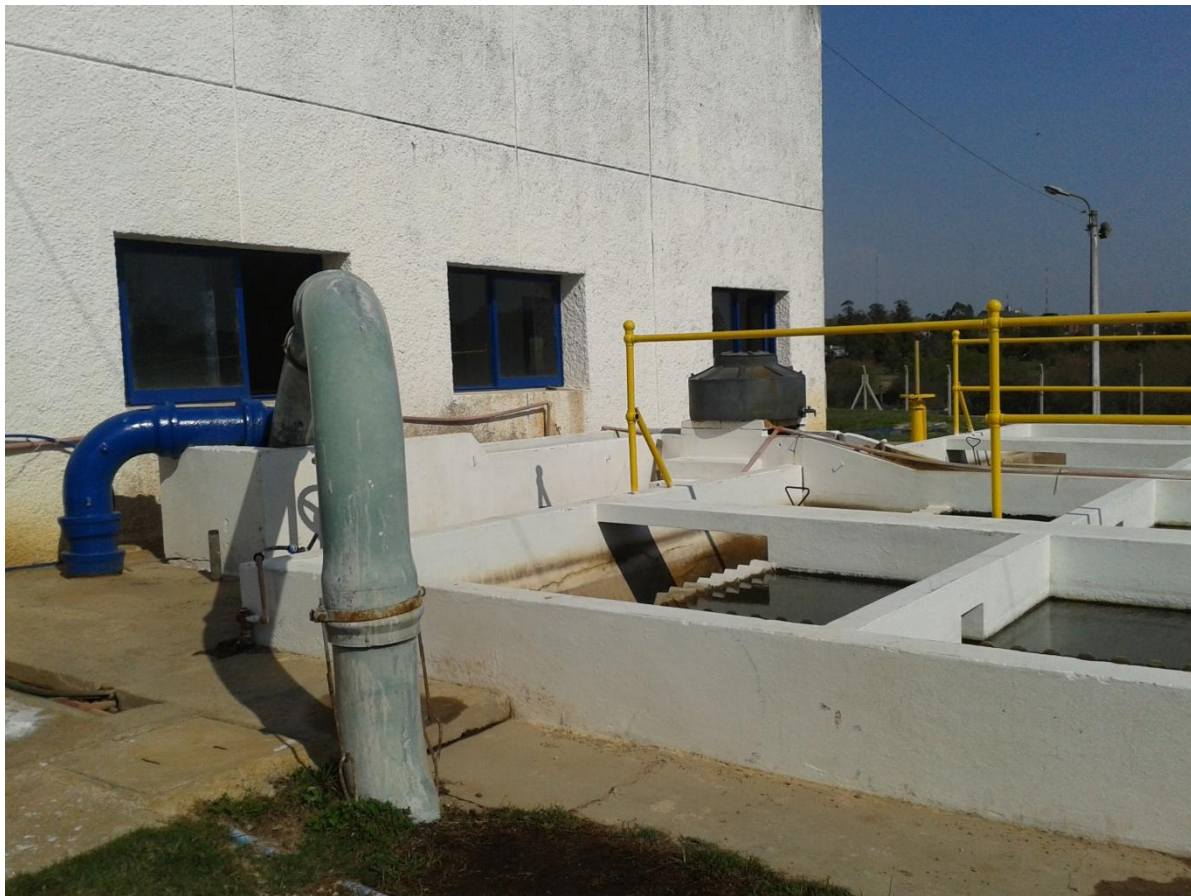
Figura 12: Llegada de agua bruta a planta de tratamiento-fin tuberías de impulsión de baja
