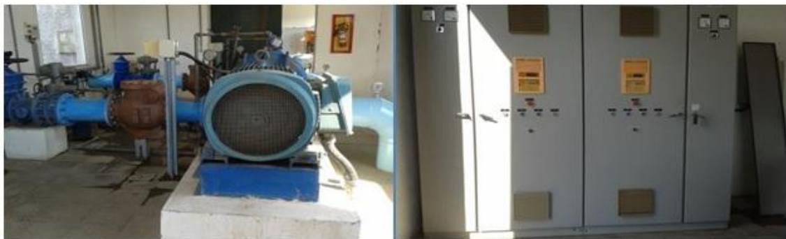
Figura 27: Sala de bombeo y tablero eléctrico
