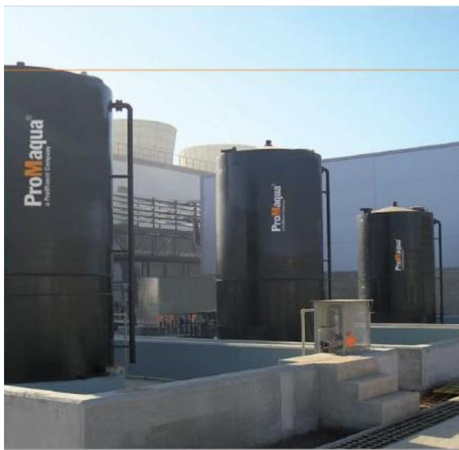
Figura 33: Tanques de acopio de productos químicos
