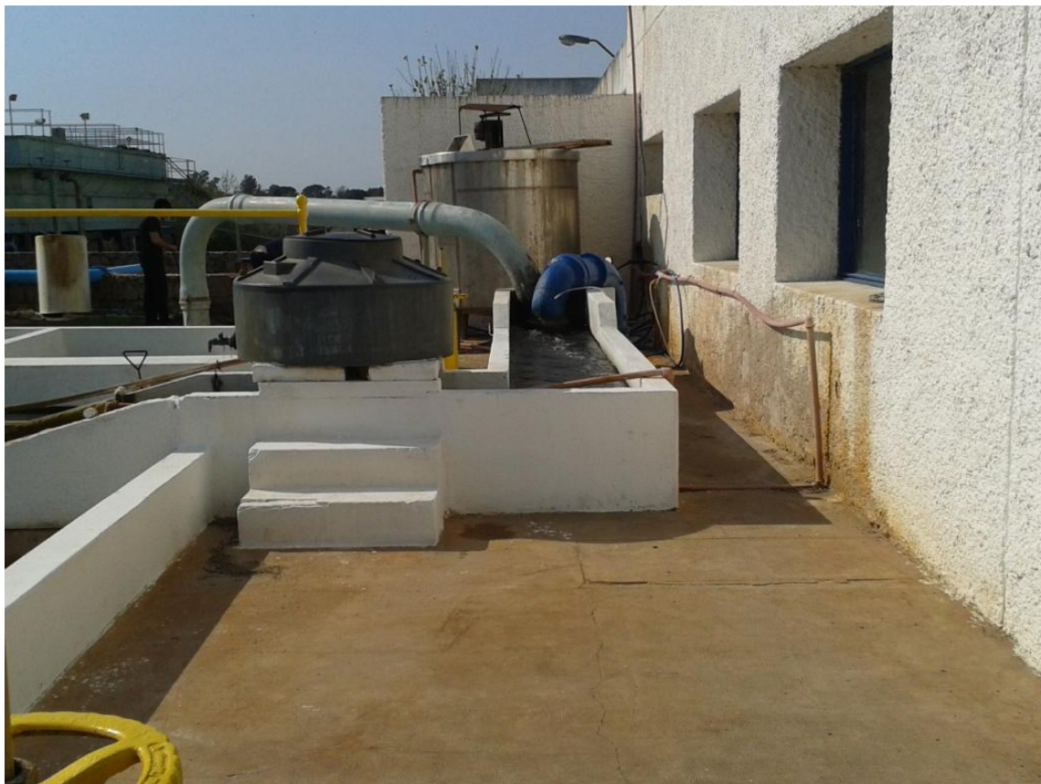
Figura 15: Tuberías de llegada de agua bruta y canal de entrada.
