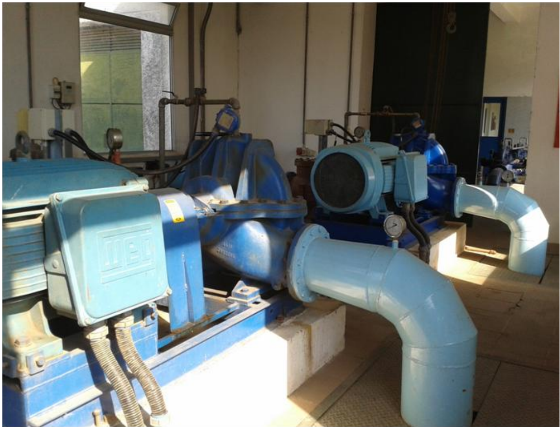
Figura 28: Sala de bombeo
