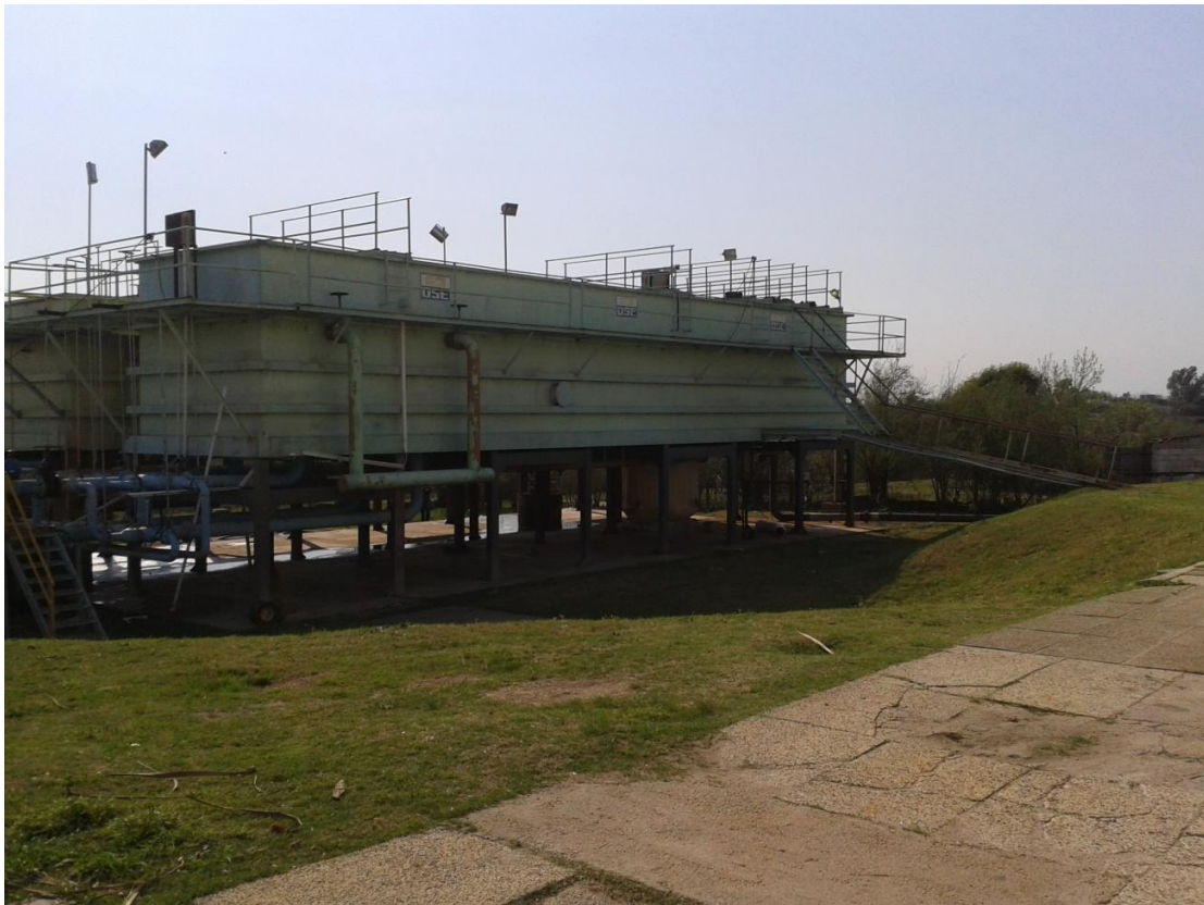
Figura 22: UPAS 2000 instaladas como apoyo a planta de Durazno
