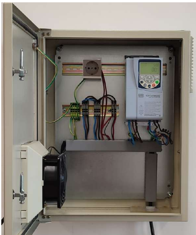
Figura 52. Variador de frecuencia.
