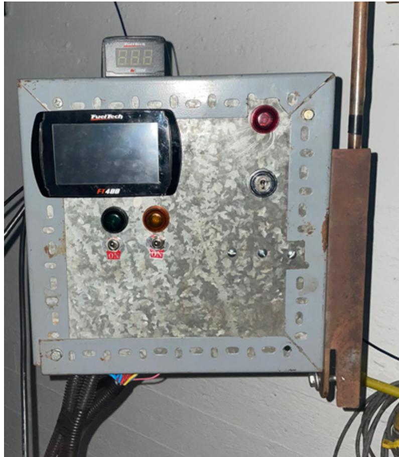
Figura A.22: Tablero donde se encuentra instalada la unidad de control programable Fueltech. Elaboración propia.
