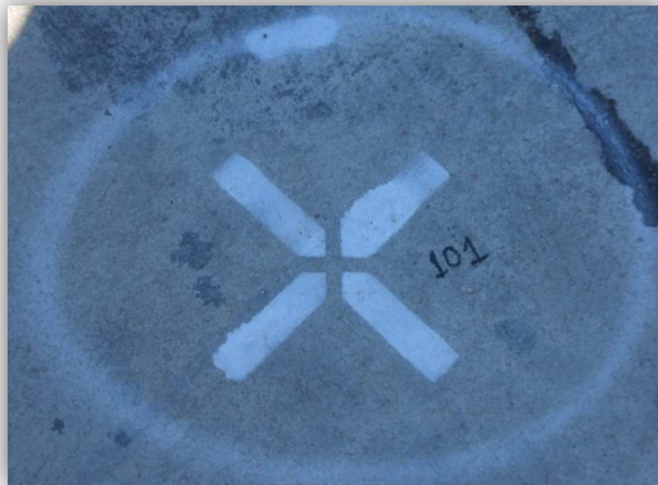
Ilustración 16: Marca de un punto de control sobre el hormigón.-
