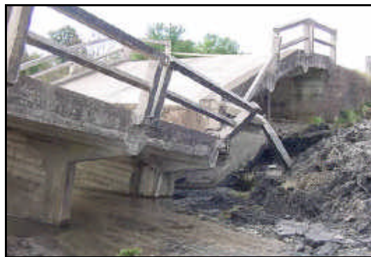
Figura 1.2. Vista del puente de la Ruta Nacional N°90 sobre el arroyo Guayabos luego del colapso del 04/07/2002.
