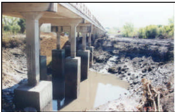
Figura 1.1. Vista de la fosa de erosión en el puente de la Ruta Nacional N°3 sobre el Arroyo de las Flores, en el año 1998. Fuente: Dirección Nacional de Vialidad.
