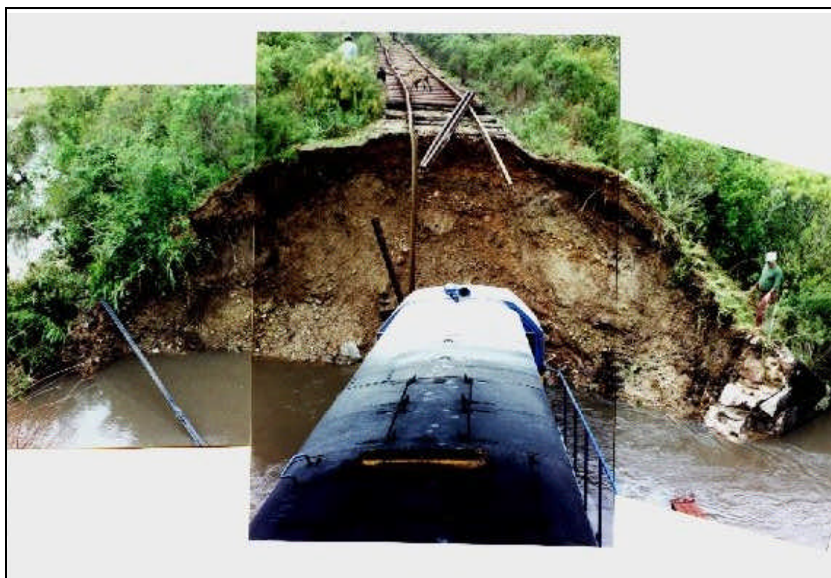
Figura 1.4. Vista desde el terraplén derecho del accidente del puente ferroviario sobre el arroyo Molles
