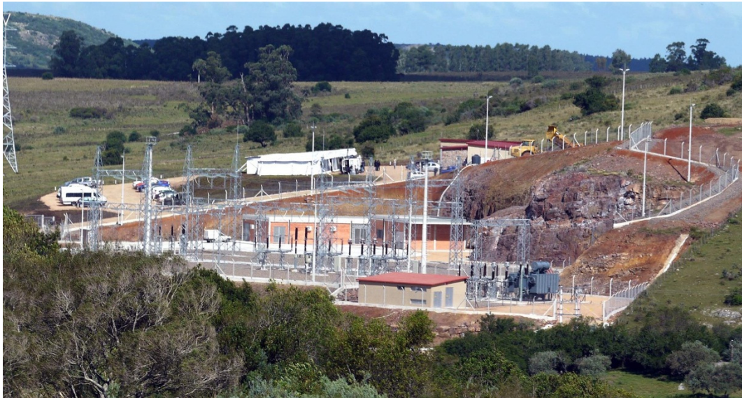
Figura 1.6: Puesto de conexión y medida “Francisco Veira” (foto cortesía R del Sur)
