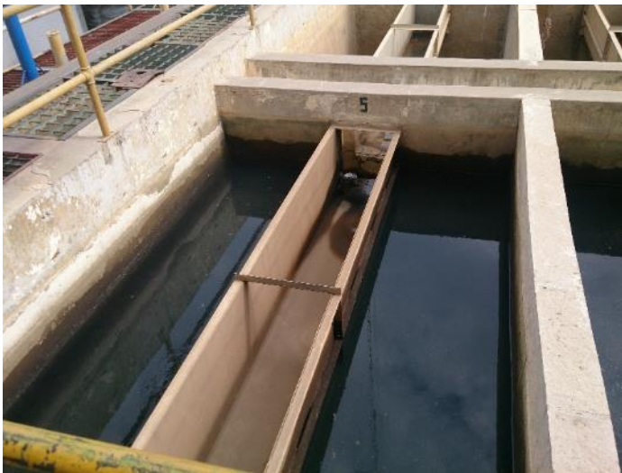
Figura 2.17. Unidad de filtración exterior
