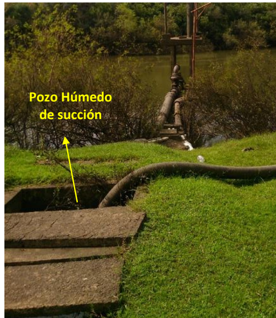
Figura 2.2. Pozo Húmedo, succión de agua bruta hacia la planta convencional.
