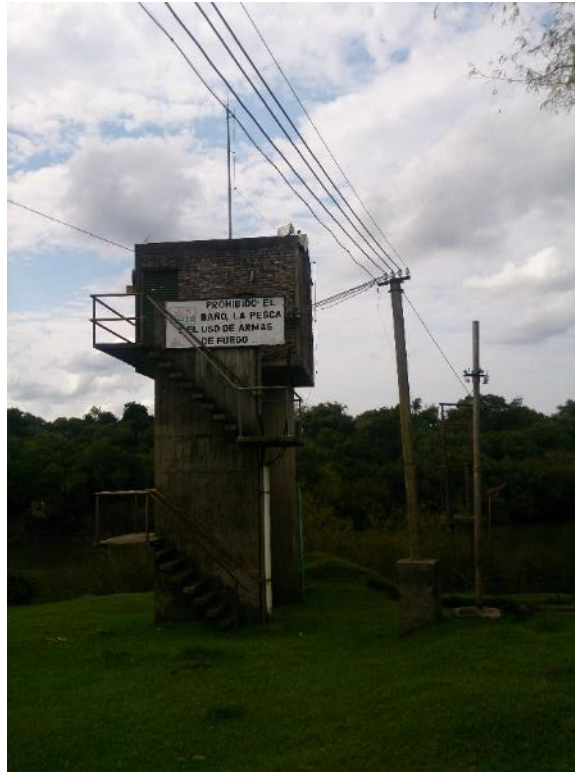
Figura 2.4. Caseta en la cual se ubican los tableros eléctricos.
