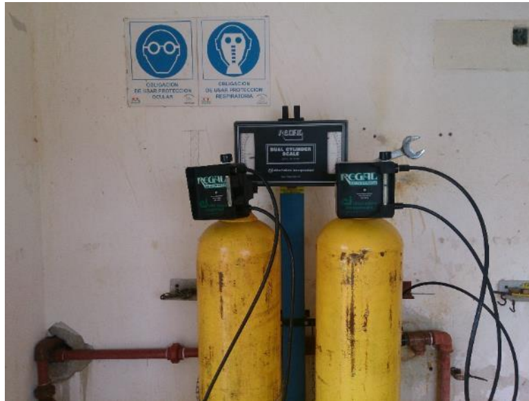
Figura 2.19. Tanques de 68kg de suministro de cloro gas.
