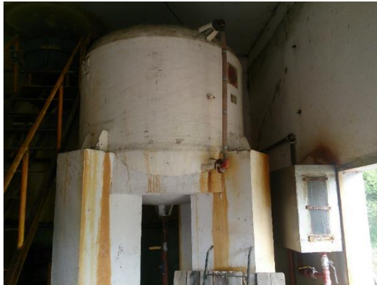
Figura 2.22. Tanque donde se realiza la re-dilución del sulfato de aluminio.
