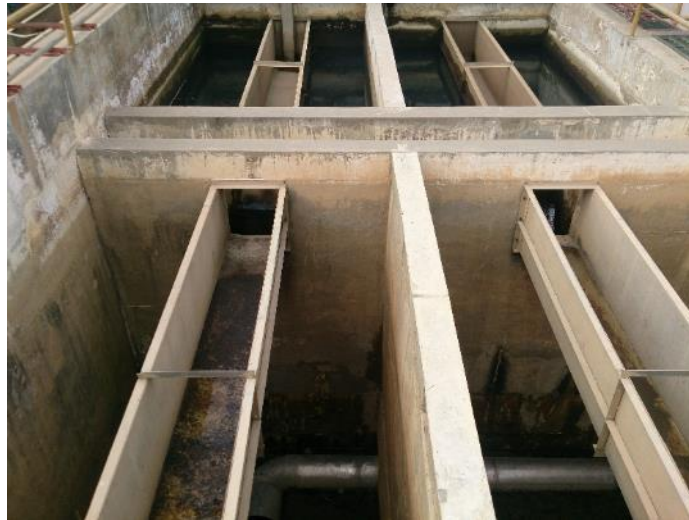
Figura 8.12 Primera línea de filtración
