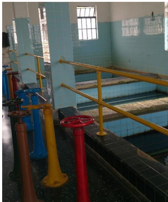
Figura 8.13 Segunda línea de filtración
