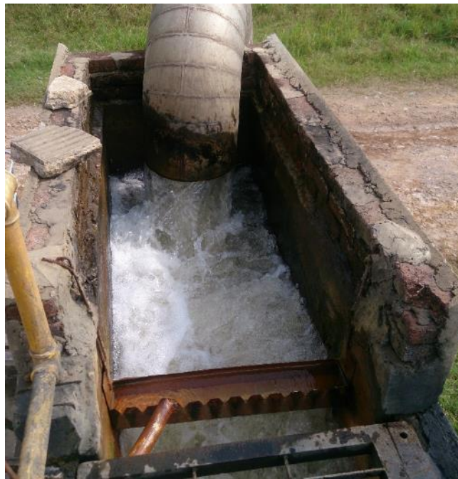
Figura 8.2 Cámara de mezcla
