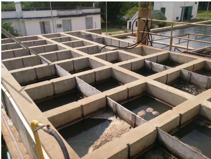
Figura 2.10. Floculador hidráulico de flujo vertical
