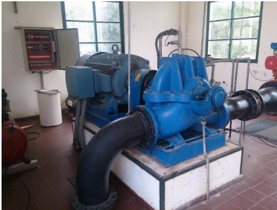
Figura 2.21. Equipo elevador de agua clarificada.
