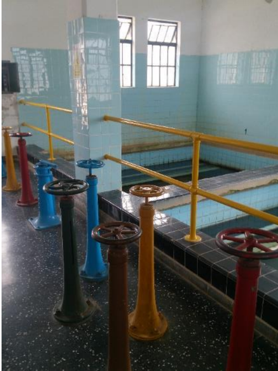
Figura 2.15. Unidades de filtros interiores, con sus respectivos volantes de operación.
