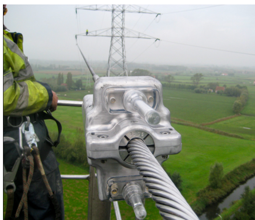
Figura 5.8: Sensor Ampacimon instalado en una línea de transmisión. Imagen extraída del sitio web de Ampacimon.
