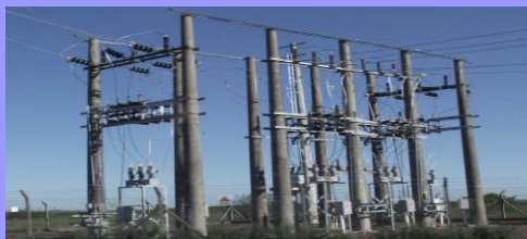
Figura: Conexión del generador de ALUR a la red de UTE. (Bella Unión).
