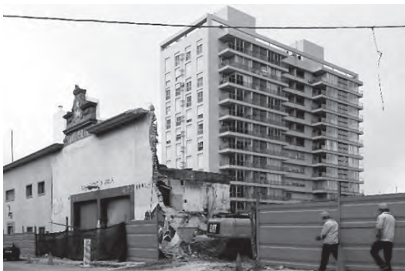
75. Sustitución deseada: demolición de la antigua fábrica La Buena Estrella y la primera torre del complejo Estrellas del Sur. Fuente: fotografía del autor.
