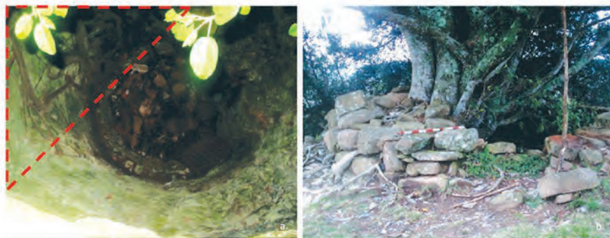
Figura 31. Crecimiento de higuero en paredes del horno Ho3. a. Detalle de crecimiento de raíces dentro de la olla de calcinación. b. Desarrollo del tronco en tramo superior de olla.
