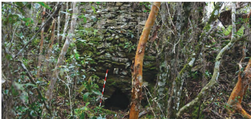
Vista general del horno. Se observa avance de sedimentos y vegetación sobre la estructura.
