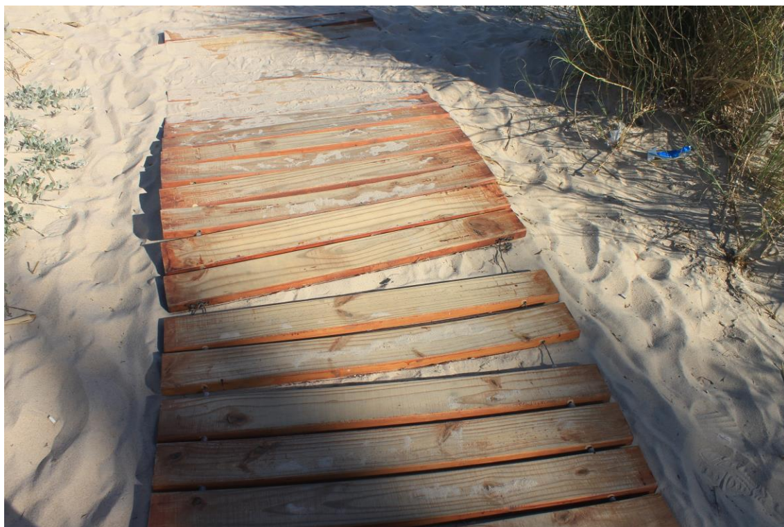
Figura N°50. Estado del mantenimiento de la pasarela en Playa Pocitos.
