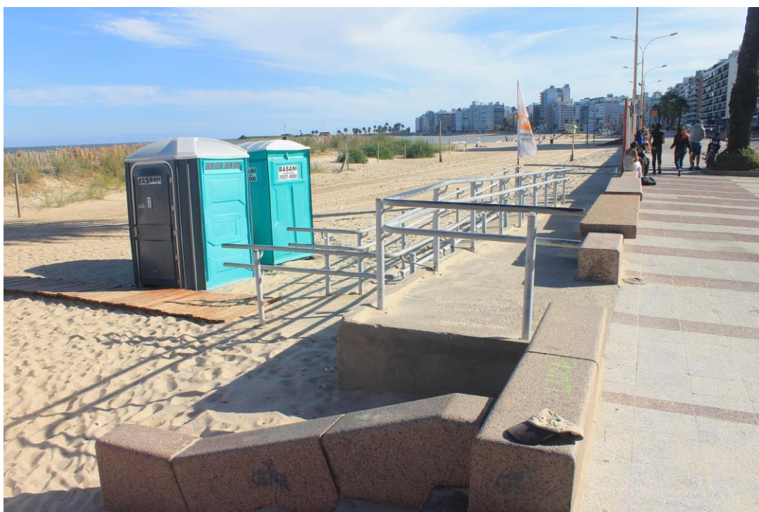
Figura N°38. Vista general de la rampa de acceso en Playa Pocitos desde la rambla.
