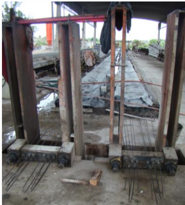
Vista de los anclajes con las cuñas presionando los cables
