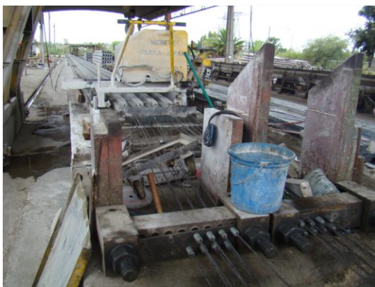
Viguetas sobre la mesa de extrusión con sus cables tensados sujetos en los anclajes en la planta II de Hopresa
