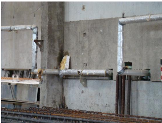
Salida de las cañerías de vapor de la sala de calderas
