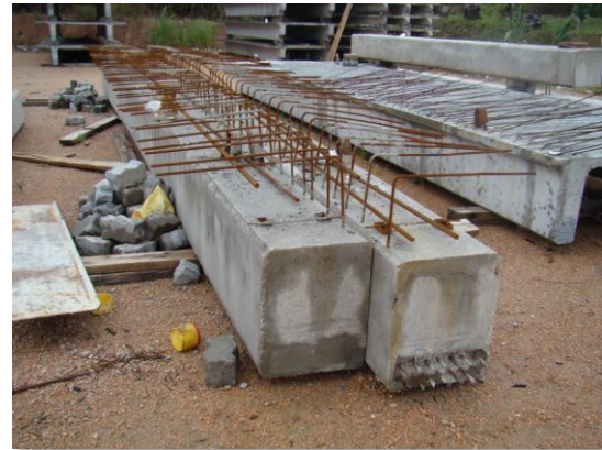
Dos vigas rectangulares con la armadura de espera y platinas para soldar previstos
