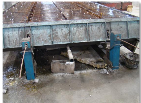
A este anclaje se engancha el gato hidráulico para el pretensado y es donde quedan las cuñas que luego se recuperan. En este panel solamente va un cable en cada nervio
