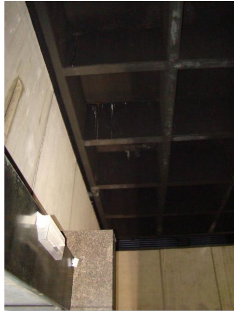
Imagen del encasetonado tomada con flash donde se pueden apreciar las patologías en la estructura
