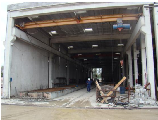
Paneles Pi colocados en la cubierta de la planta de producción de Flasur, donde se pueden observar sus lucernarios
