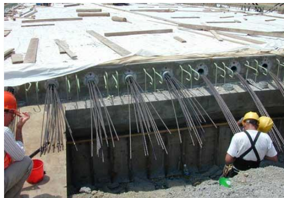
Placas de anclaje de los cables de postesado
