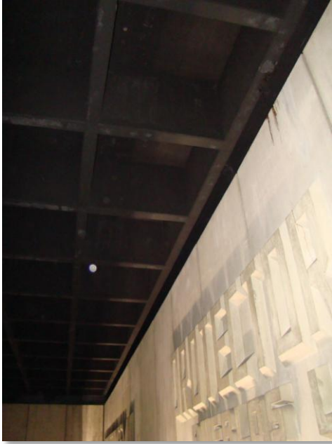
Humedades en la estructura encasetonada
