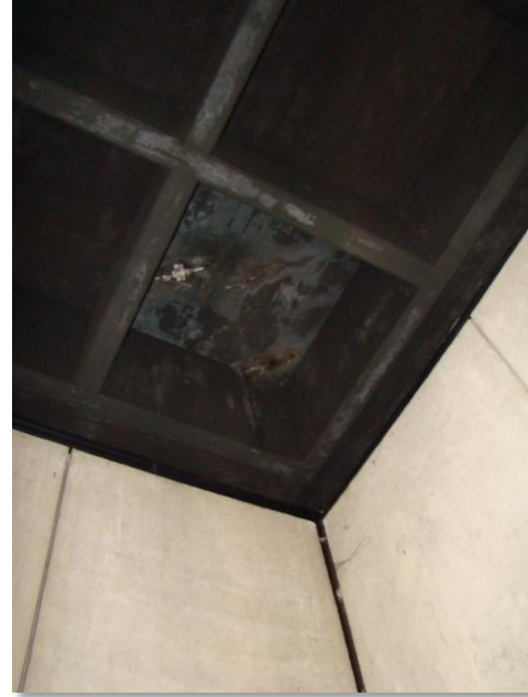
Humedades en la estructura encasetonada y herrumbre de las armaduras
