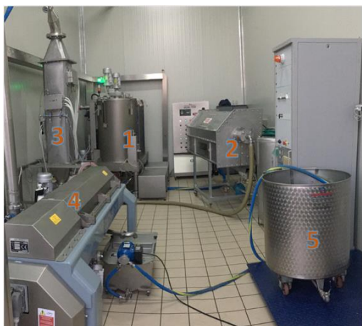
Figura 3.1. Instalación de planta de procesamiento industrial que incluye (1) batidora, (2) generador de MW y tubo, (3) equipo de megasonido, incluidos transductores. (4) decanter centrífugo, (5) tanque de equilibrio, como se describe en detalle en Leone et al. (2018).
