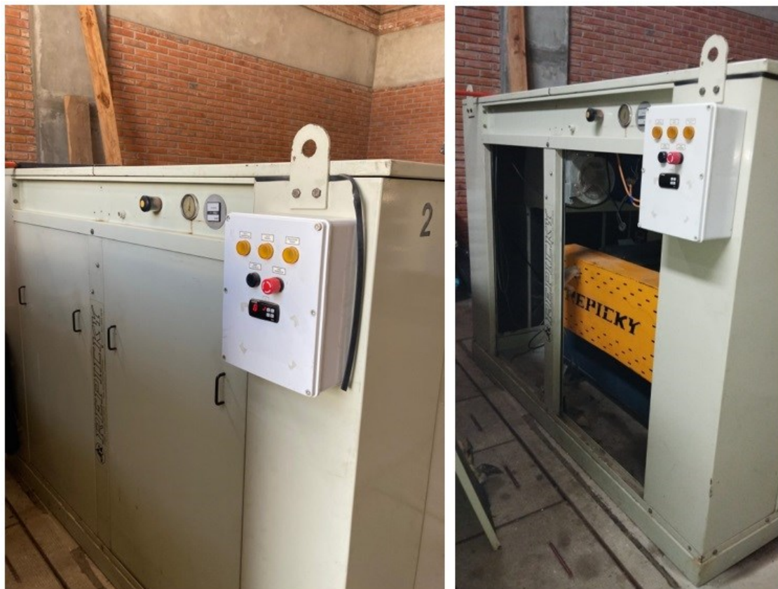
Fotografía 5-1 - Soplante con y sin cubierta (izquierda y derecha, respectivamente). Fuente: Edison Cáceres (Encargado de Saneamiento Minas, OSE).
