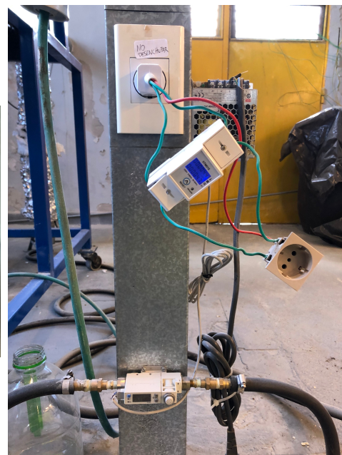
(b) Medidor de energía para compresor
