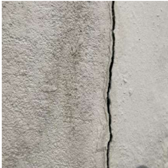
(a) Crack en hormigón.
