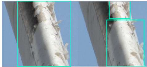
Figura 4.10: Daño difícil de localizar.
