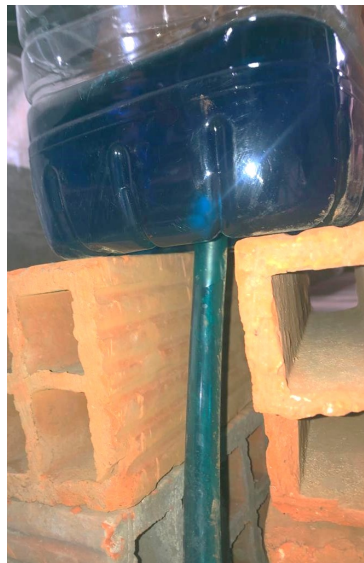
Figura 5.5: Conexión del tanque DrainBack con la impulsión de la bomba.
