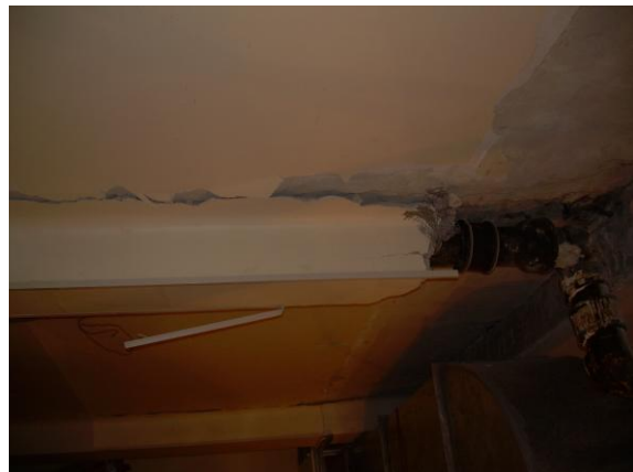
IMAGEN 5:12 VIGA DAÑADA POR LA EXPLOSIÓN
