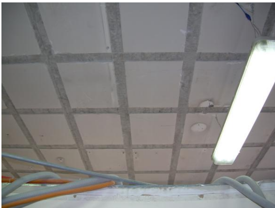
IMAGEN 5:13 PICADO DE REVOQUES
