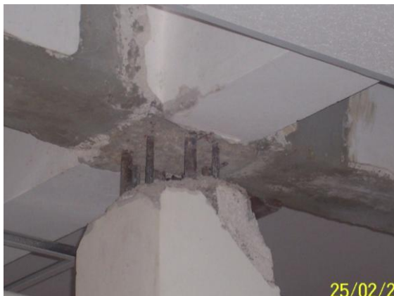
IMAGEN 5:5 VIGA SEMI INVERTIDA CON TENSOR – PICADO DE HORMIGÓN PARA ATRAVESAMIENTO DE REFUERZOS
