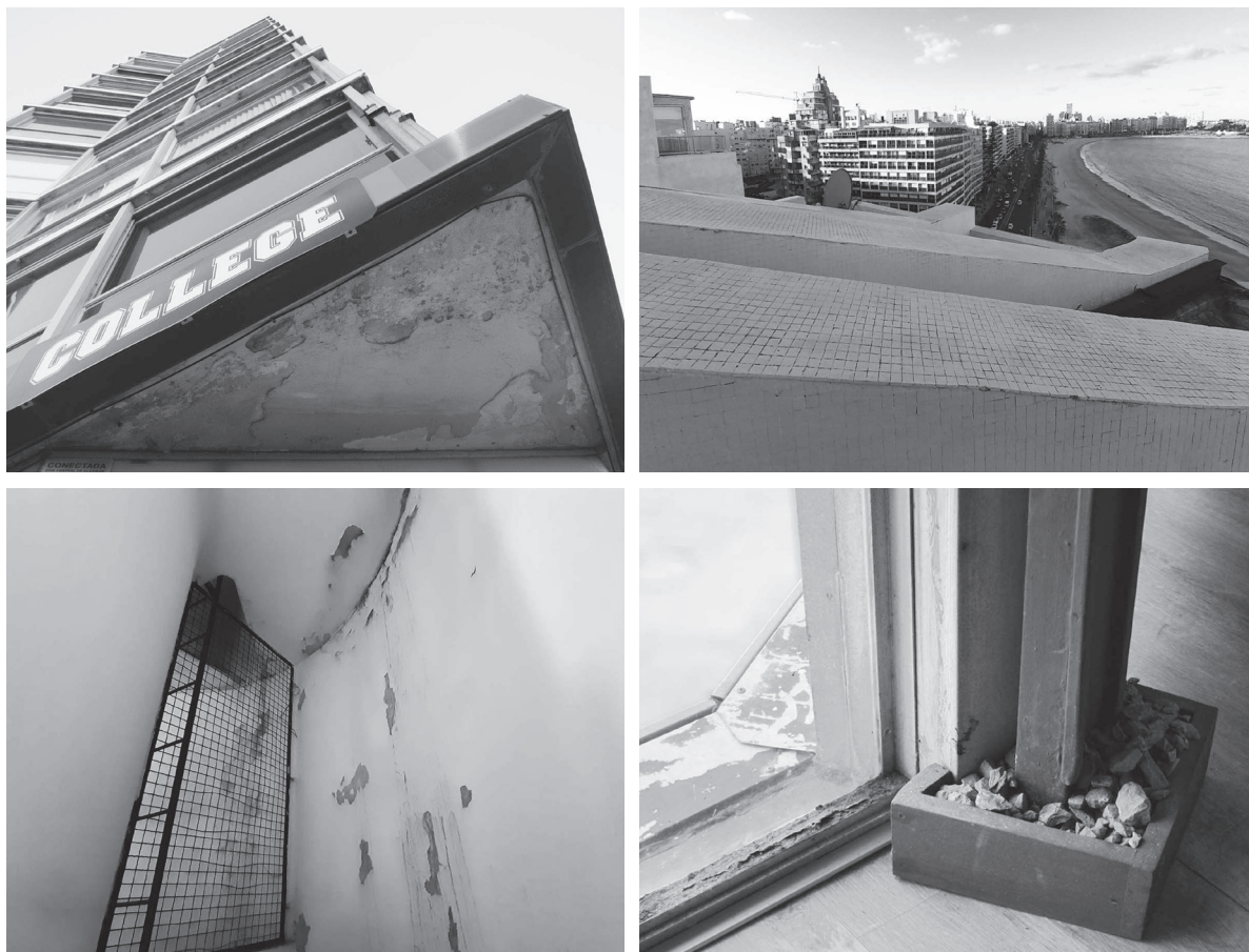
Figura 7. Fotografías del edificio: (a) descascamientos en cara inferior de la losa del primer nivel; (b) vigas del nivel de la cubierta; (c) manchas de humedad en el interior del pilar cilíndrico, por debajo de la azotea; (d) reparación realizada a un tensor. Imágenes del autor.
