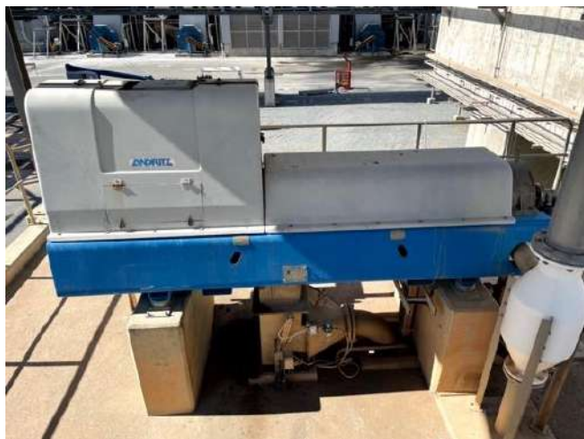
Figura 16: Centrífuga, espesamiento del lodo "B" para producir el lodo "C" (LTAB)
