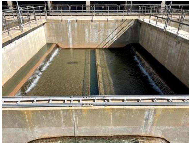
Figura 12: Filtros de Arena, luego de la etapa de clarificación del agua bruta
