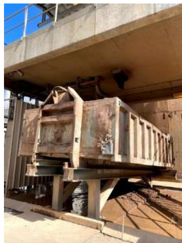
Figura 17: Tolva a la salida de la Centrífuga, recibe el lodo "C" (LTAB)
