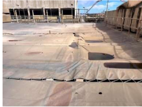
Figura 10: Clarificadores de Contacto
