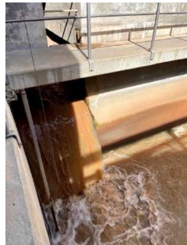
Figura 13: Tanque de Lodo Clarificado, recepción del lodo "A"
