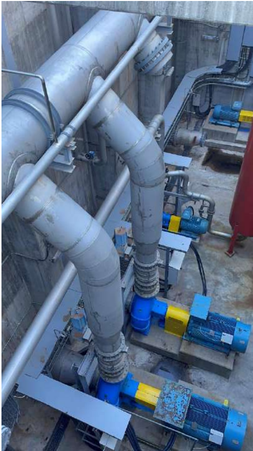
Figura 9: Sistema de bombeo
