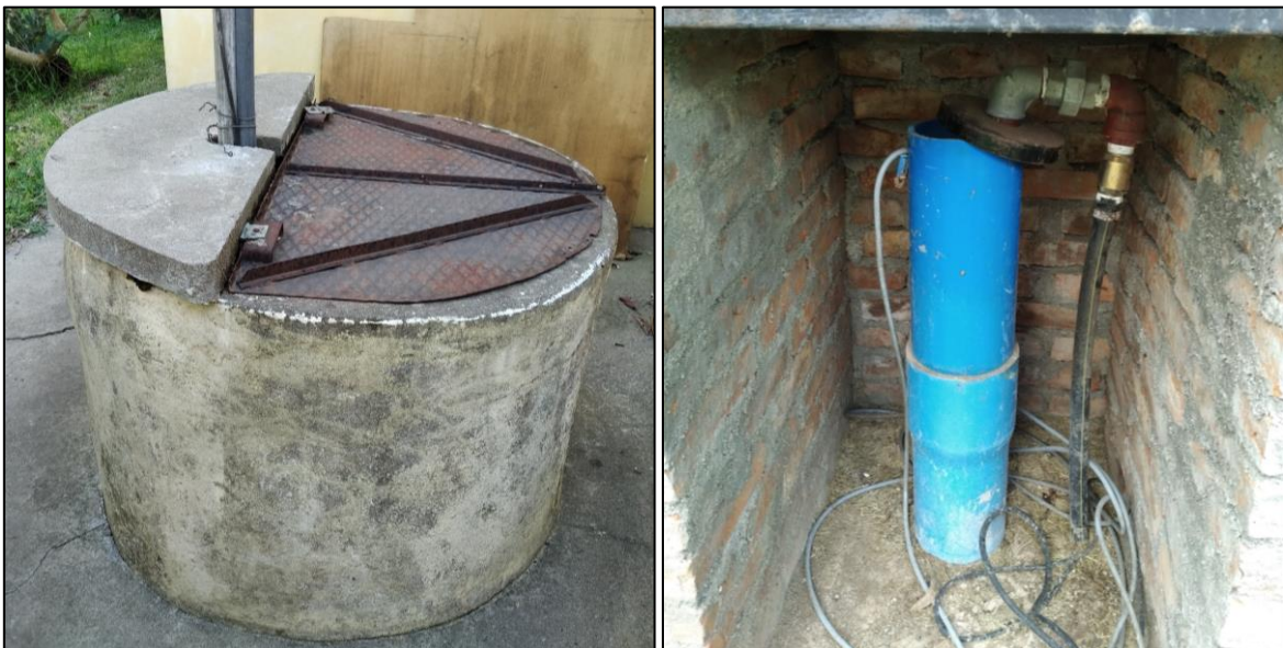
Figura 15. Pozo brocal (izquierda), pozo semisurgente (derecha).
