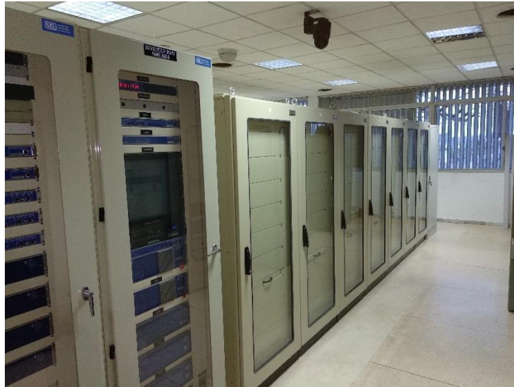
Imagen 4 - Paneles de equipos de protección y control
