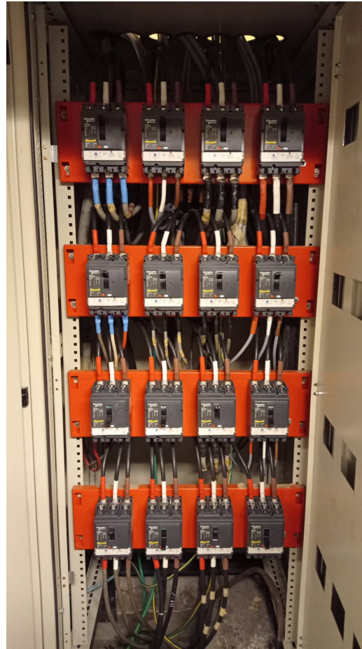
Figura 5.1: Interior de Tablero Eléctrico Anexo Sur.
