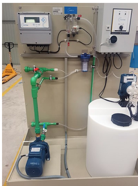
Figura N°6: Sistema automático de cloración
