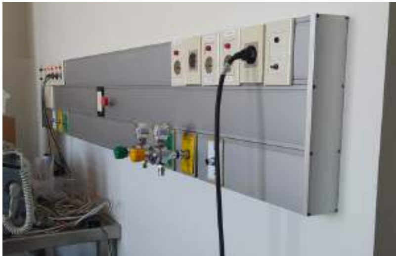
Imagen de estación de suministro de electricidad, aire, oxígeno y otros gases médicos del hospital de clínicas
