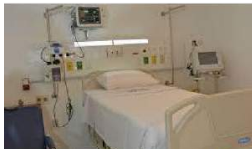
Ejemplos de tomacorrientes detrás de camas hospitalarias
