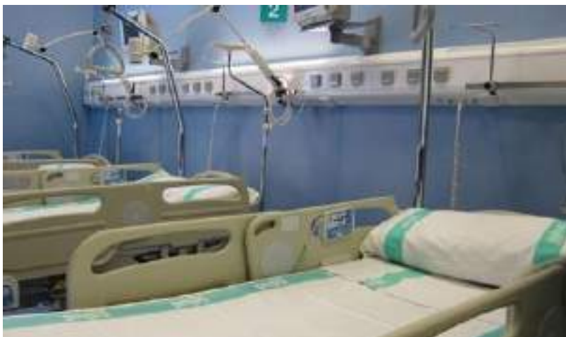
Ejemplos de tomacorrientes sobre camas hospitalarias
