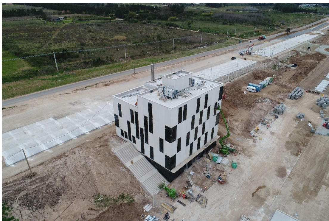
Fig. 5a. Proceso de obra edificio Centro Administrativo. Vista desde suroeste. Fuente: Recaudos proporcionados por UAM - CA
