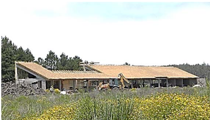
Ilustración 205. Portal del Polonio I Cubierta: asimetría formal que asume las diferentes orientaciones. Fotografía gentileza Arq. Federico Gastambide.
