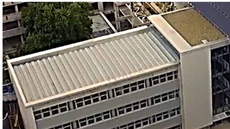
Ilustración 297. Centro Parque Battle | Cubierta cierre con chapa curva autoportante. Fotografía de Plan de Obras de la Udelar.
