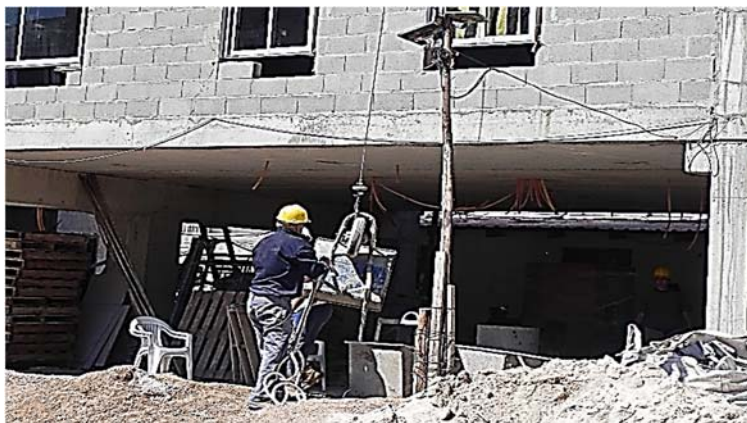
Ilustración 180. Covicordón I Trabajos tradicionales; elevación de hormigón para confección en contrapisos en obra. Fotografía gentileza Unidad Permanente de Vivienda.
