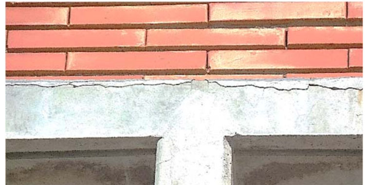
Ilustración 300. Instituto de Producción Animal | Fisuración por posible diferencia de dilatación de materiales. Fotografía de autor.
