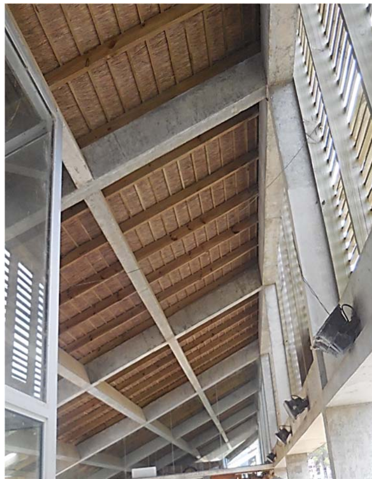
Ilustración 165. Portal del Polonio | Cubierta: estructura en hormigón armado, cierre con quinchá. Fotografía de autor.
