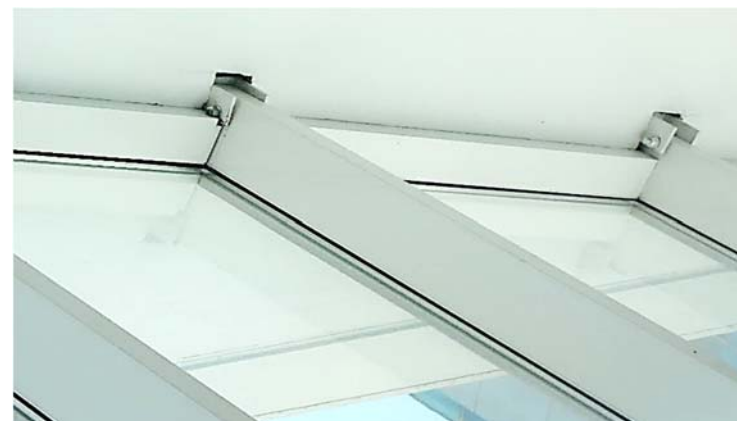
Ilustración 146. Anexo Torre Ejecutiva | Encuentro sujeción curtain wall, estructura principal y cielorraso liviano. Fotografía de autor.
