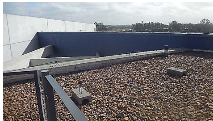
Ilustración 310. Data Center I Recorridos de instalaciones independientes de la cubierta. Fotografía de autor.
