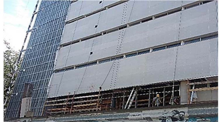
Ilustración 134. Centro Parque Batlle I Fachada acceso. Sistema de cierre. Estructura metálica y emplacado. Fotografía de autor.
