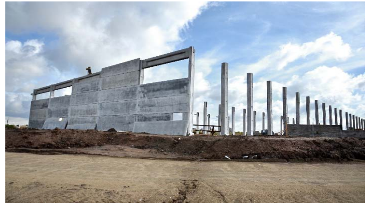
Ilustración 128. Data Center I. Estructura de paneles y pilares prefabricados distribuidos únicamente en el perímetro. Fotografía gentileza Arq. Carlos Rodríguez.
