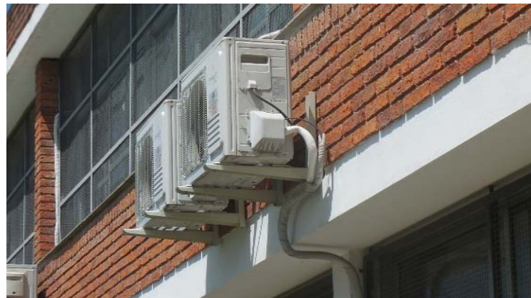
Ilustración 287. Escuela 296 Pando Sur I Unidades exteriores de aire acondicionado agregadas en la fase de uso. Fotografía de autor.
