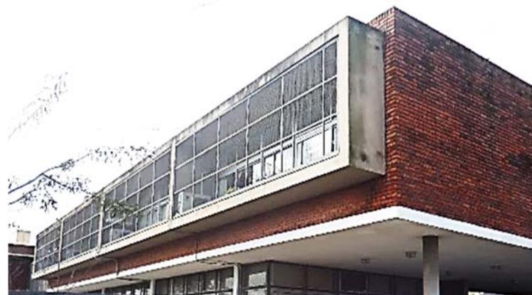
Ilustración 288. Escuela 296 Pando Sur I Presencia de agentes bióticos (hongos) sobre la superficie de ladrillo visto. Fotografía de autor.
