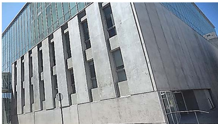
Ilustración 164. Anexo Torre Ejecutiva | Fachada este: cerramiento vidriado y piezas ciegas prefabricadas de hormigón. Fotografía de autor.
