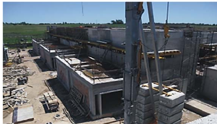
Ilustración 175. Instituto de Producción Animal | Sistema constructivo tradicional. Andamios tubulares y grúa pluma Fotografía gentileza Arq. Daniel Calzada.
