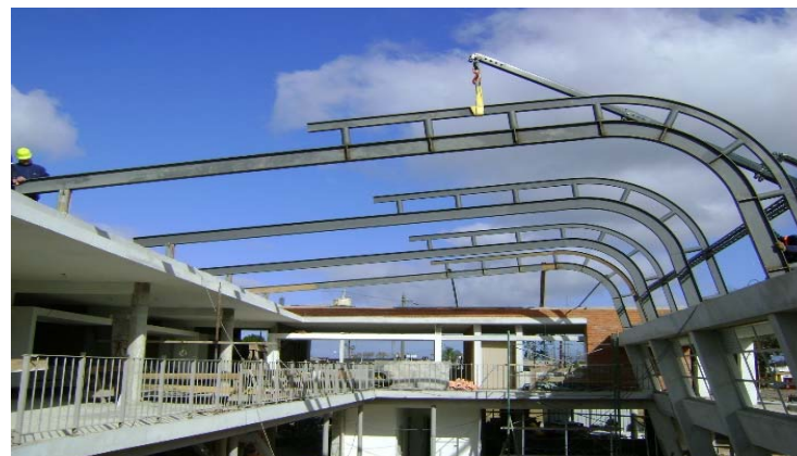
Ilustración 170. Escuela 296 Pando Sur I Estructura cubierta metálica: perfiles laminados curvados en taller. Fotografía gentileza PAEPU.
