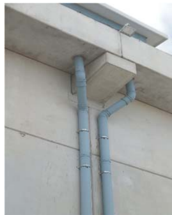
Ilustración 309. Data Center I Instalación de desagüe. Fotografía de autor.
