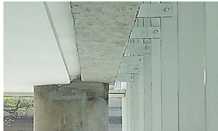
Ilustración 145. Anexo Torre Ejecutiva | Detalle interfaz estructura de hormigón armado y estructura curtain wall. Fotografía de autor.
