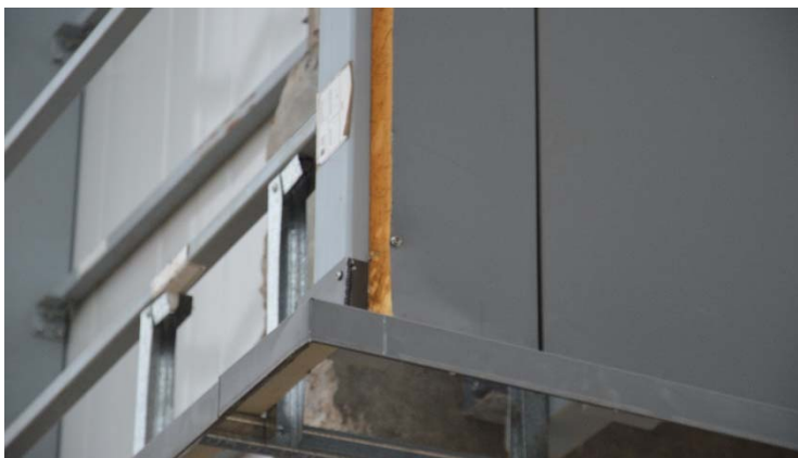
Ilustración 261. Sanatorio del Banco de Seguros del Estado | Ajuste de piezas para juntas y terminaciones. Fotografía de autor.
