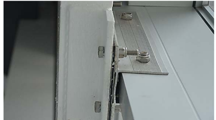
Ilustración 135. Centro Parque Batlle I Detalle de fijación entre estructuras metálicas. Fotografía de autor.
