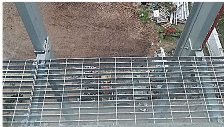
Ilustración 295. Centro Parque Battle | Pasarela paralela a la fachada para tareas de mantenimiento. Fotografía de autor.
