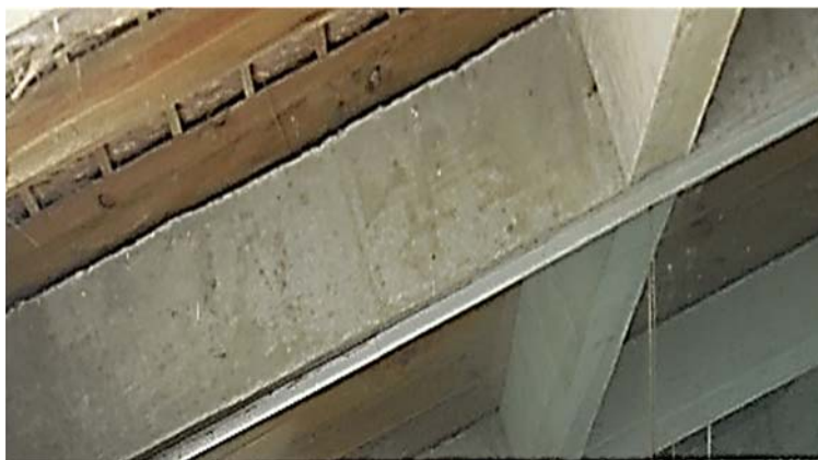
Ilustración 148. Portal del Polonio | Estructura de cubierta. Retícula de vigas coplanares y pilares de hormigón armado. Fotografía gentileza Arq. Federico Gastambide.
