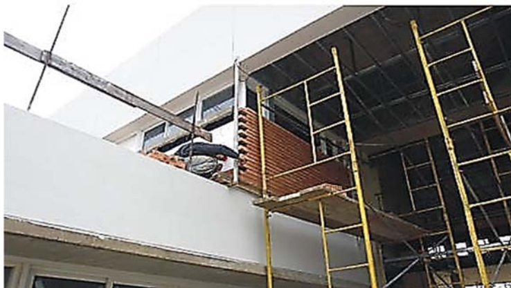
Ilustración 142. Instituto de Producción Animal | Detalle ejecución revestimiento ladrillo y paños revocados. Fotografía gentileza Arq. Daniel Calzada.
