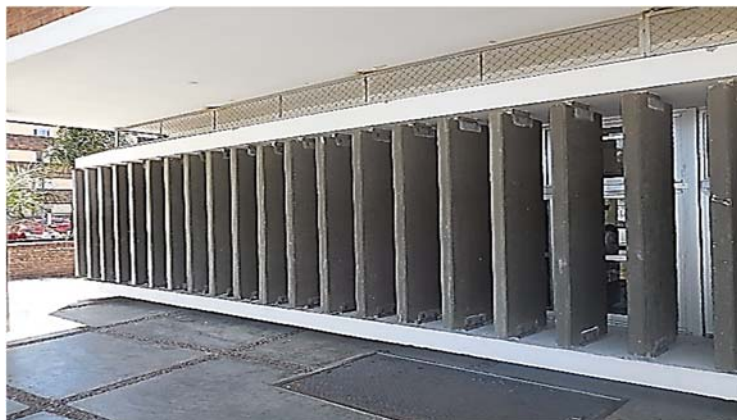
Ilustración 155. Escuela 296 Pando Sur | Sistema de parasoles fijos de hormigón armado. Fotografía de autor.
