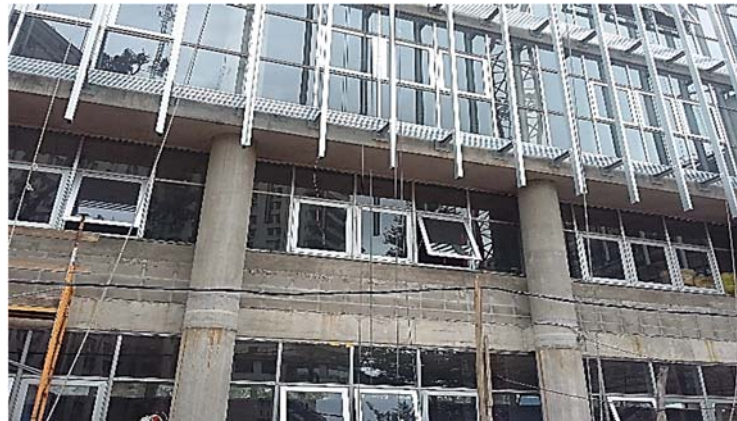
Ilustración 122. Centro Parque Batlle | Propuesta de estructura en hormigón armado con bordes libres Fotografía de autor
