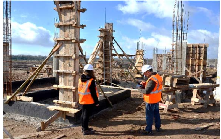
Ilustración 167. Data Center I Edificio de clientes: sistema tradicional en sitio de losa, viga y pilar. Fotografía gentileza Arq. Carlos Rodríguez.
