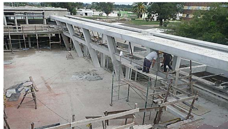
Ilustración 186. Escuela 296 Pando Sur I Trabajos de albañilería en viga canalón de apoyo de cubierta metálica. Fotografía gentileza PAEPU.
