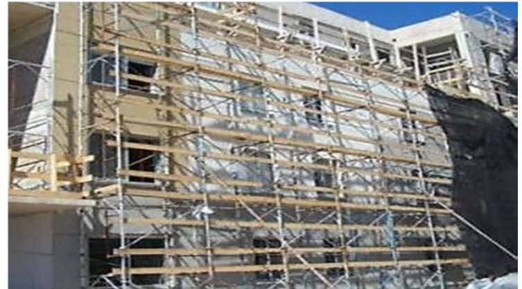
Ilustración 182. Covicordón | Sistema de andamios tubulares para tareas de terminaciones de fachada. Fotografía gentileza Unidad Permanente de Vivienda.
