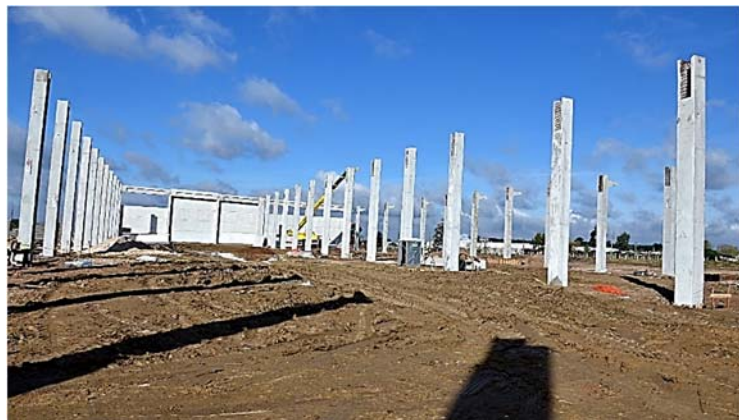
Ilustración 273. Data Center I Edificio de servicios: estructura prefabricada independiente de instalaciones. Fotografía gentileza Arq. Carina Curbelo.
