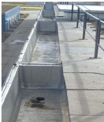
Ilustración 308. Data Center I Canalón para pluviales. Fotografía de autor.
