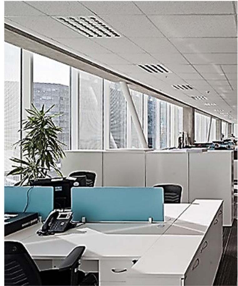
Ilustración 301. Anexo Torre Ejecutiva | Instalaciones de acondicionamientos próximas al plano de fachada vidriada. Fotografía de autor.
