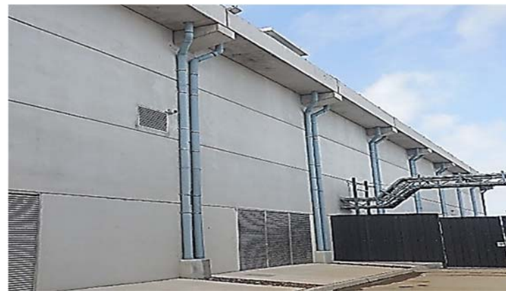
Ilustración 153. Data Center I Edificio de servicios. Concepción y materialización a partir de lógica industrializada. Fotografía de autor.
