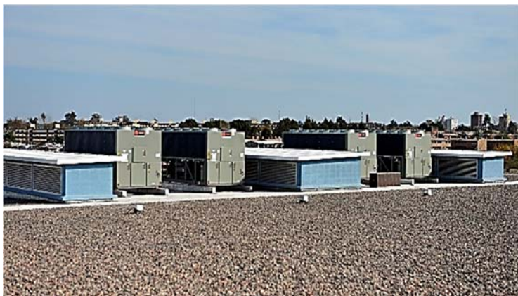
Ilustración 286. Equipos de acondicionamiento artificial con estructura independiente de apoyo sobre pretiles. Fotografía gentileza Arq. Carina Curbelo.
