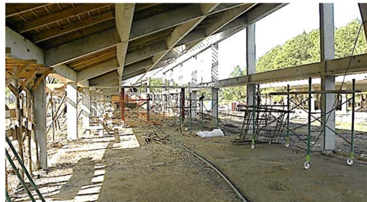
Ilustración 179. Portal del Polonio | Organización de obra: sistema de andamios tubulares móviles. Fotografía gentileza Arq. Federico Gastambide.
