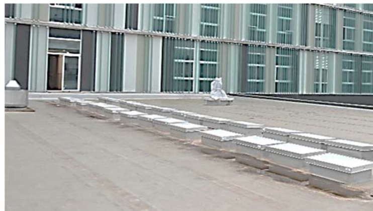
Ilustración 292. Sanatorio Banco de Seguros del Estado | Cubierta: interferencia lucernarios al escurrimiento de agua. Fotografía de autor.
