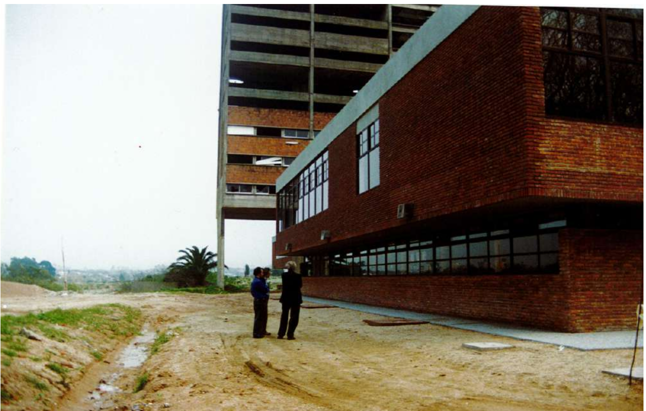
FIGURA 44 ▲ Fotografía de las obras de la etapa 1, en la misma aparece el Proyectista y Director de Obra Arq. Pablo Briozzo. Archivo DGA-UdelaR, escaneo.
