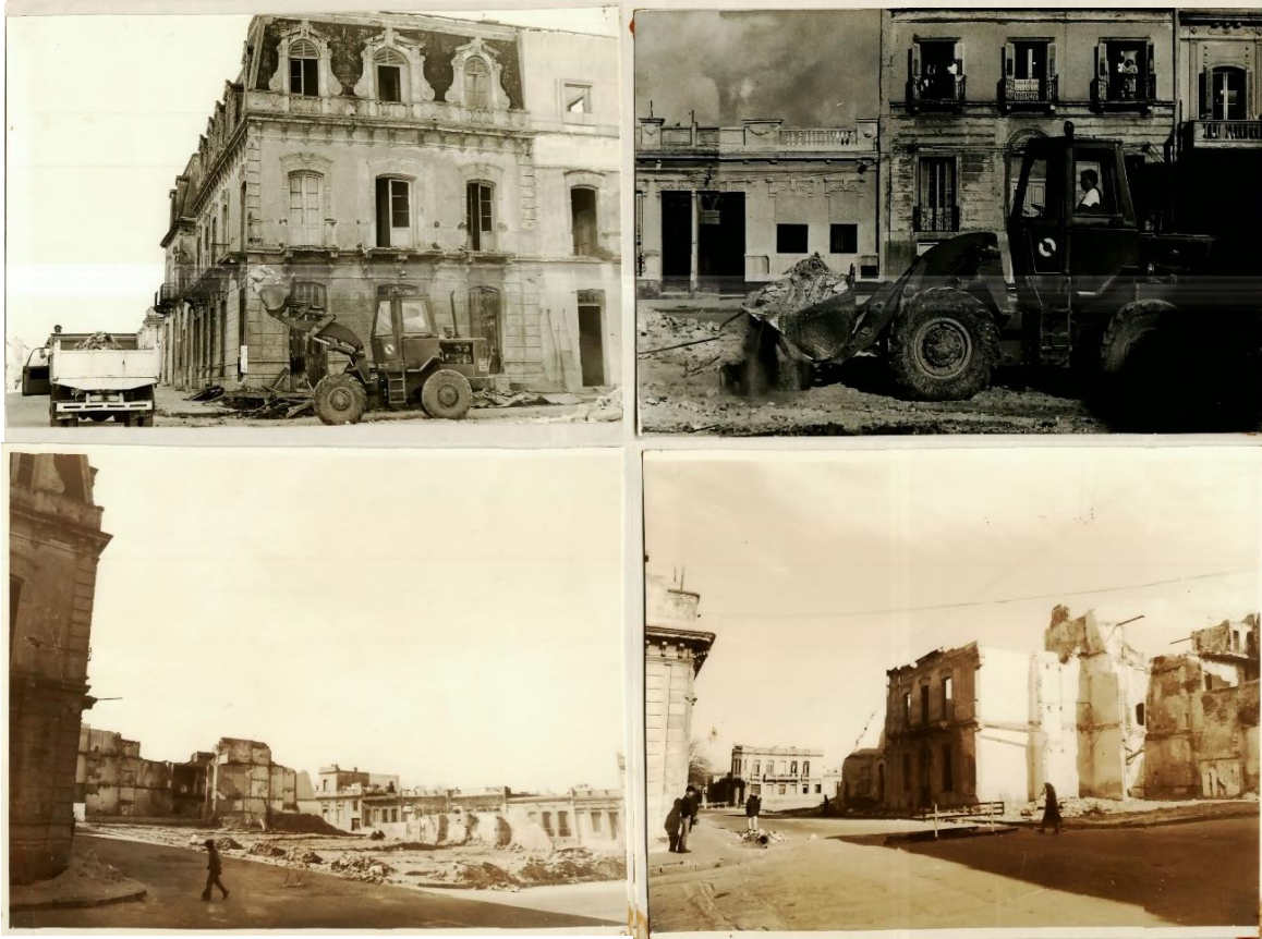
FIGURA 52. FOTOGRAFÍA DEL BARRIO REUS AL SUR PREVIA Y DURANTE SU DEMOLICIÓN. FECHA: S/D. FUENTE: ARCHIVO GEU – IHA.
