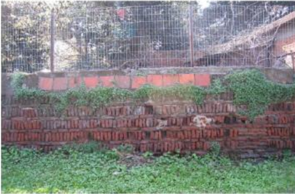
Remanentes de muro de ladrillos de la época de Basáñez, foto tomada para el diploma de Patrimonio en el año previo a la finalización de las obras que se realizarán para el nuevo Hospital Pasteur.
