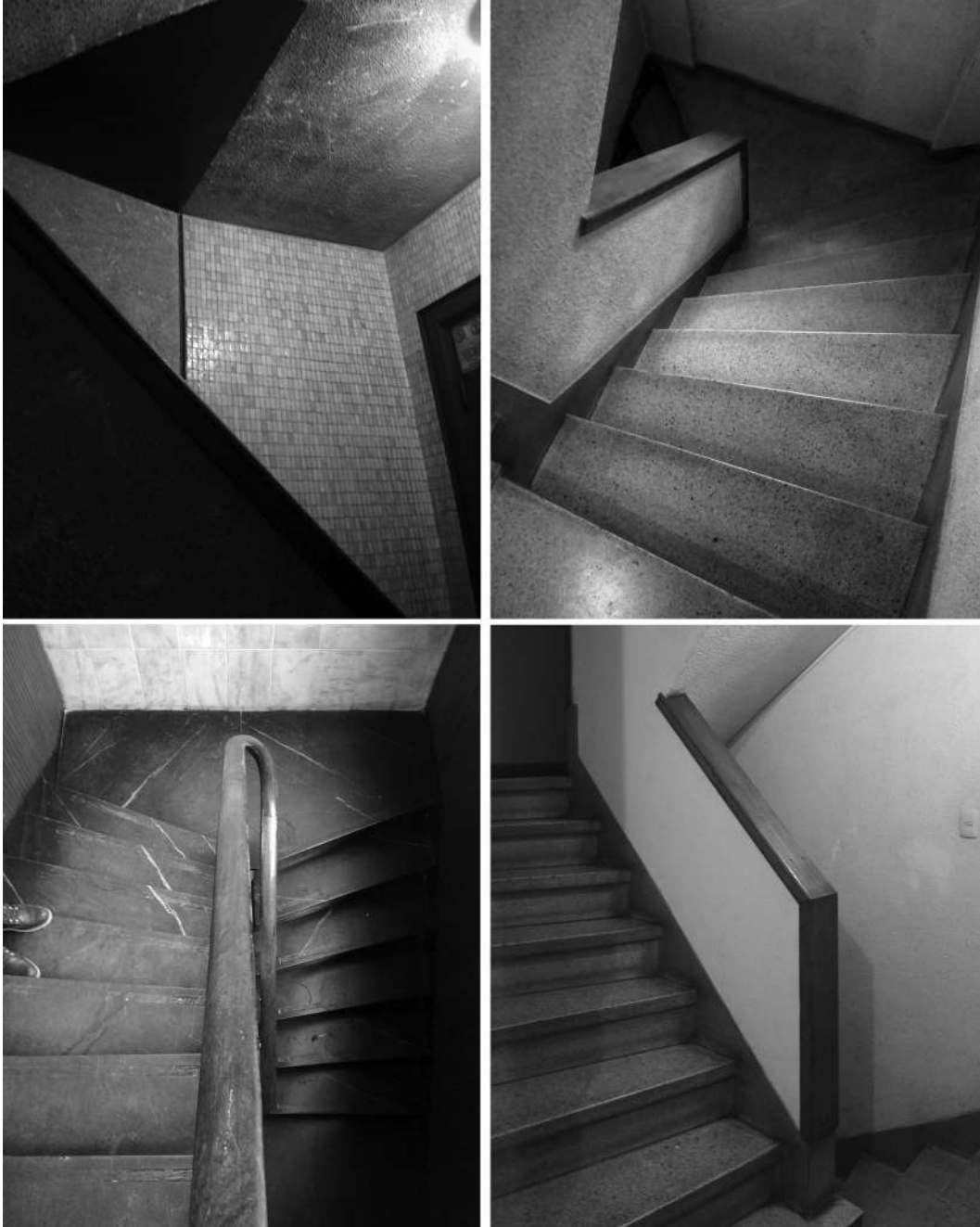
Figura 2.13: Pielés pétreas del BCLA: circulaciones verticales del núcleo. Nuevamente los revestimientos en pisos de áreas públicas se ejecutan con pétreos. Se aprecia el uso del monolítico en las escaleras de servicio mientras que en la del tesoro se recurre al mármol negro. Los pasamanos en cambio se resuelven en madera. La pastilla veneciana viste únicamente el acceso a la circulación desde el pallier .
