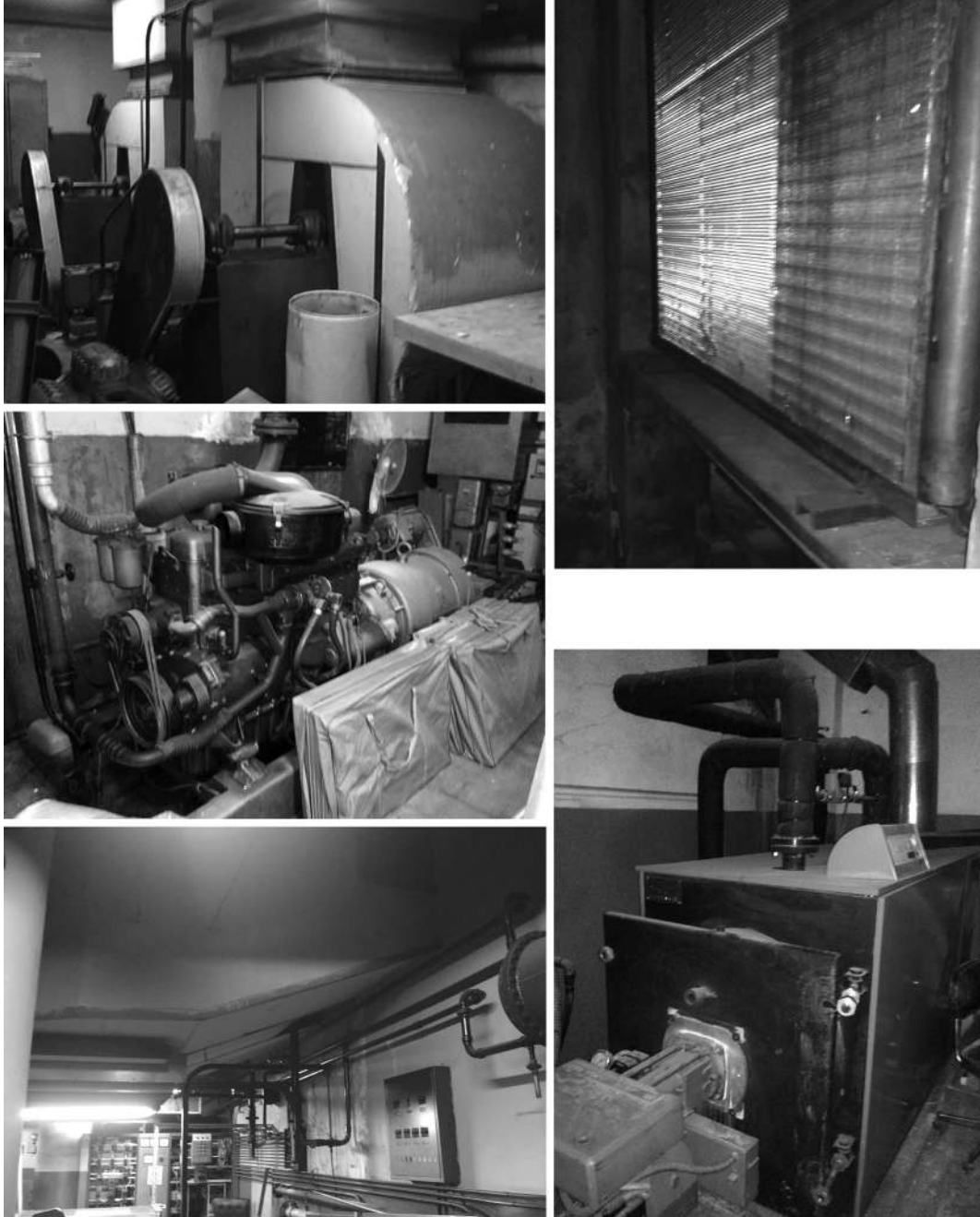
Figura 2.8: Equipamiento existente en la sala de máquinas del tercer subsuelo del BCLA. Se aprecian los ventiladores de inyección de aire, el compresor para el sistema de frío, los ductos de retorno sobre el tablero eléctrico, la caldera (no original) y los serpentines del convector.
