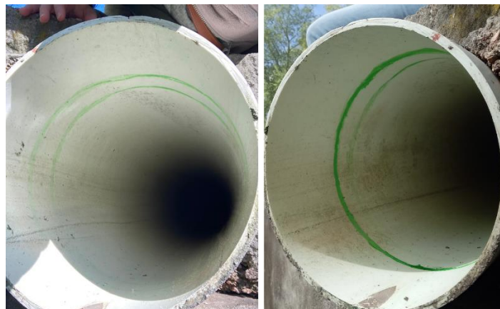
Figura 20: Indicador de máximo en tubería de alivio de Calle 6, se observan las marcas de pintura previo al evento del 27/08/2022 (der) y posterior al evento (izq).
