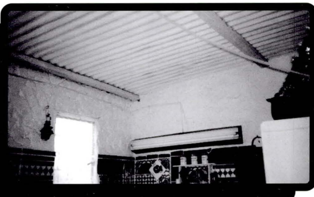
Techo inclinado de chapas de zinc sobre tirantes de eucalipto. Revestimiento de baño con azulejos de segunda mano.
